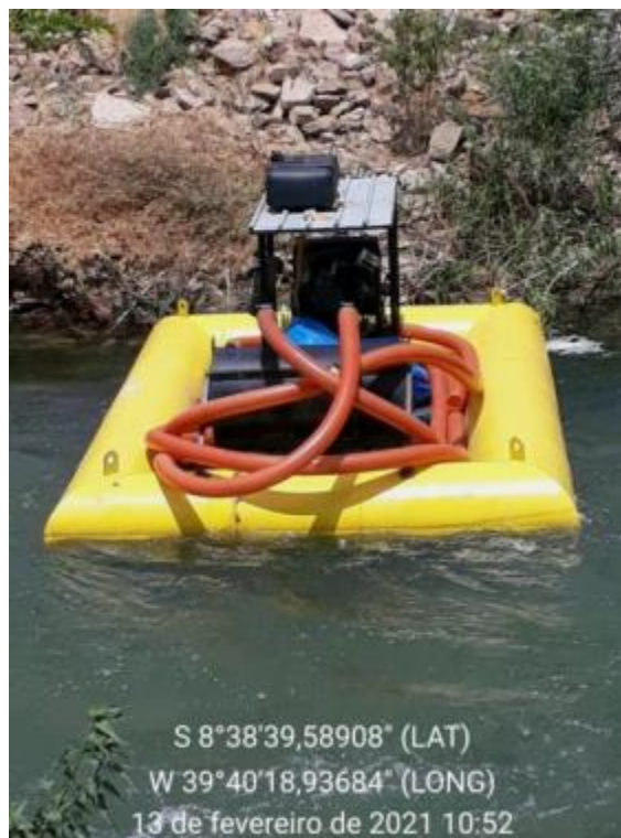
Figura 257 – Captação Flutuante Fonte: INSTITUTO GESOIS, 2021.
