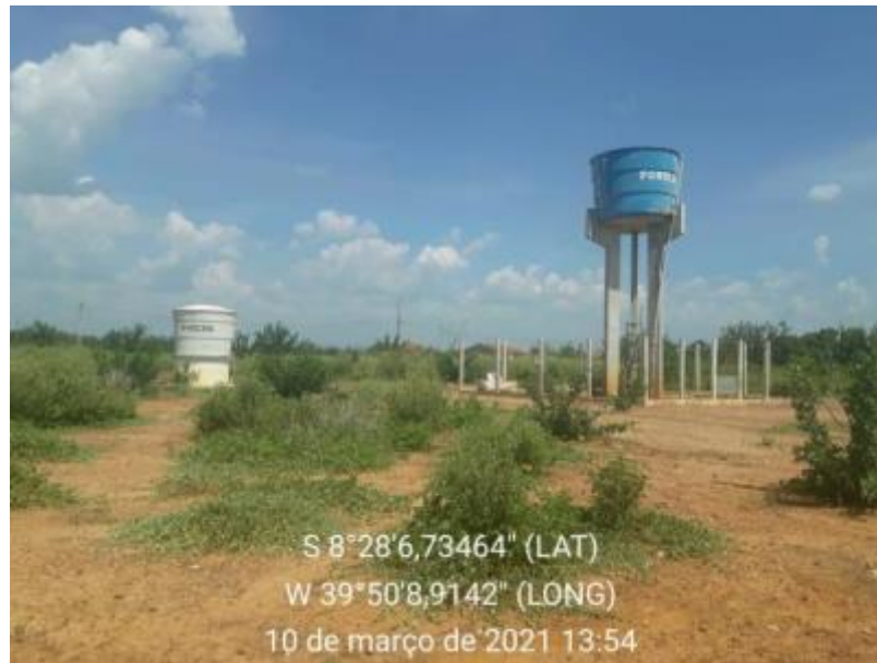
Figura 169 – Poço Subterrâneo, Reservatório 10.000 L Fonte: INSTITUTO GESOIS, 2021.
