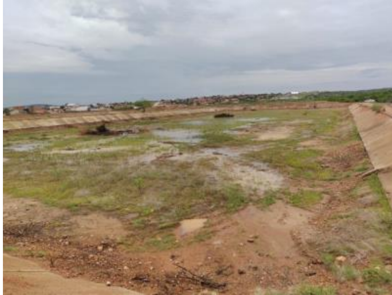
Figura 351 – ETE, Lagoa de Estabilização Fonte: ANA, 2021.
