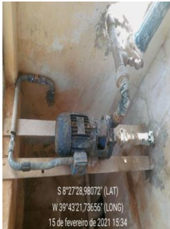
Figura 260 – Casa de Bombas Fonte: INSTITUTO GESOIS, 2021.
