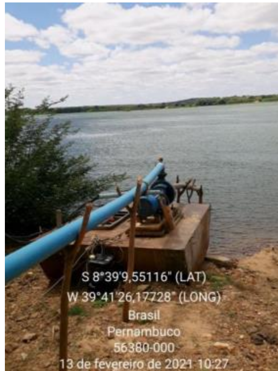
Figura 252 – Captação Fonte: INSTITUTO GESOIS, 2021.
