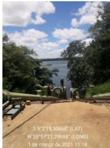
Figura 233 – Captação Fonte: INSTITUTO GESOIS, 2021.
