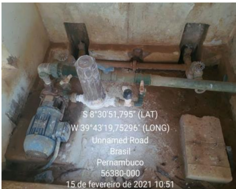
Figura 259 – Casa de Bombas Fonte: INSTITUTO GESOIS, 2021.
