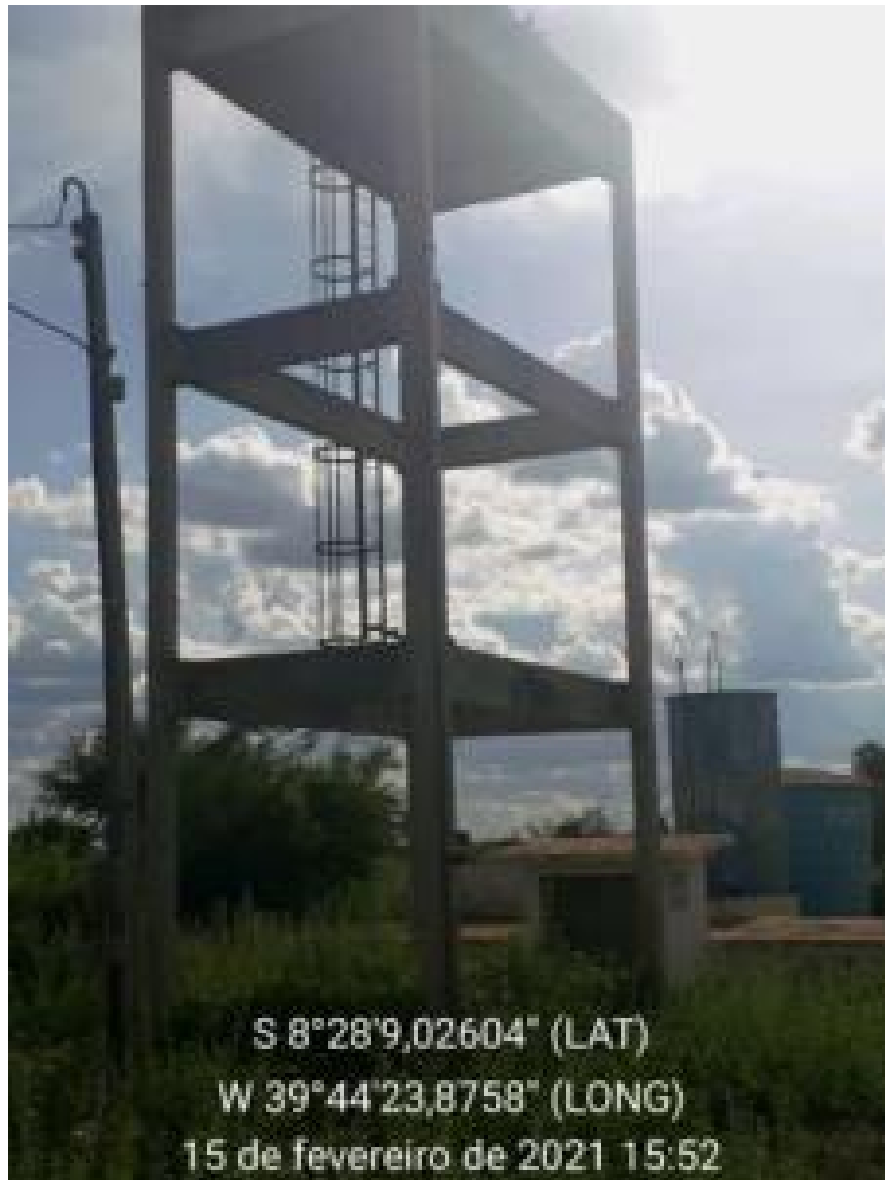
Figura 306 – Reservatório Fonte: INSTITUTO GESOIS, 2021.
