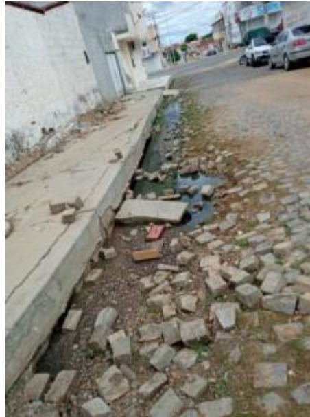
Figura 355 – Esgoto a Céu Aberto Fonte: INSTITUTO GESOIS, 2021.
