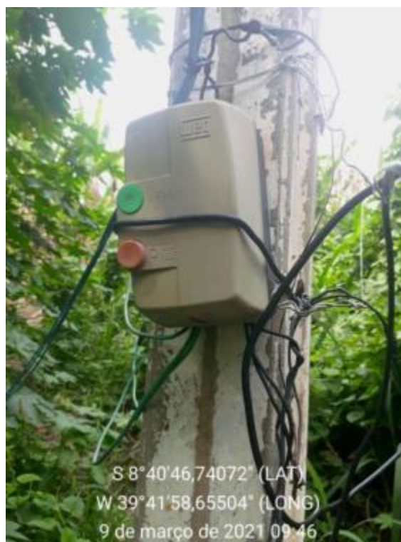
Figura 214 – Disjuntor Fonte: INSTITUTO GESOIS, 2021.
