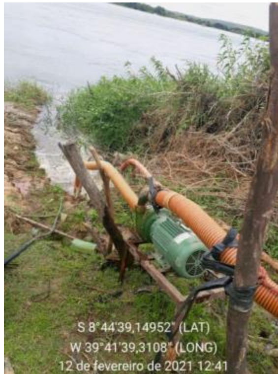
Figura 109 – Captação Serrote (CODEVASF) Fonte: INSTITUTO GESOIS, 2021.
