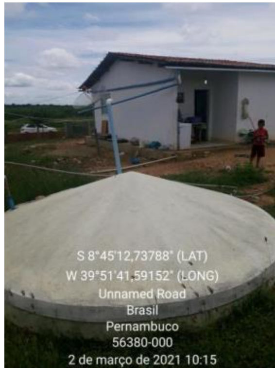
Figura 128 – Cisterna Fonte: INSTITUTO GESOIS, 2021.
