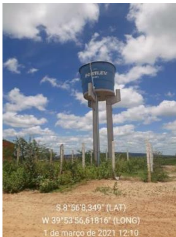
Figura 250 – Reservatório Fonte: INSTITUTO GESOIS, 2021.
