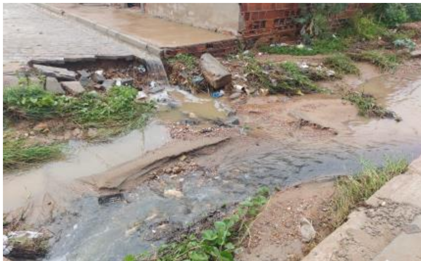
Figura 430 – Sistema de microdrenagem inadequado Fonte: INSTITUTO GESOIS, 2020.
