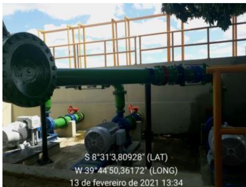
Figura 271 – Estação de Bombeamento I Fonte: INSTITUTO GESOIS, 2021.
