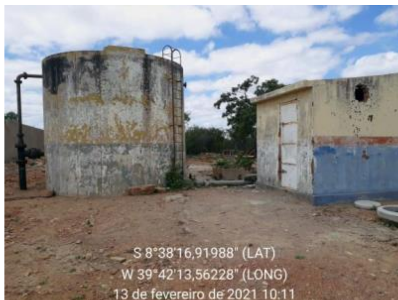
Figura 253 – Reservatório Fonte: INSTITUTO GESOIS, 2021.
