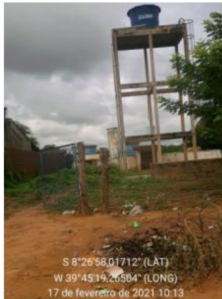
Figura 321 – Elevatória Fonte: INSTITUTO GESOIS, 2021.
