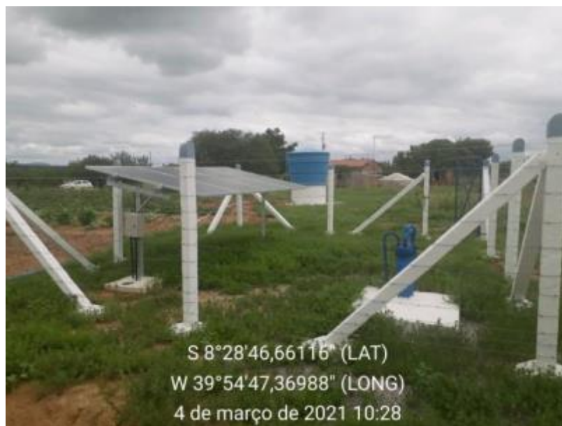
Figura 71 – Poço Subterrâneo à Energia Solar Fonte: INSTITUTO GESOIS, 2021.
