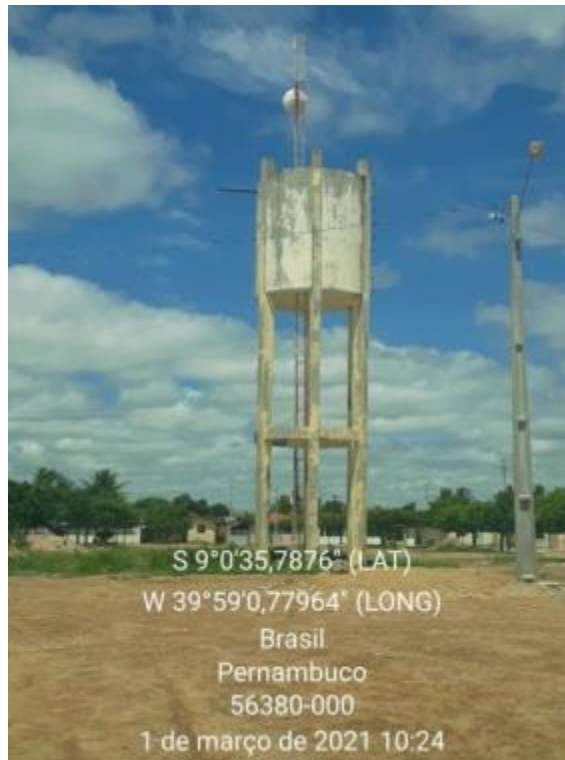
Figura 237 – Reservatório Fonte: INSTITUTO GESOIS, 2021.
