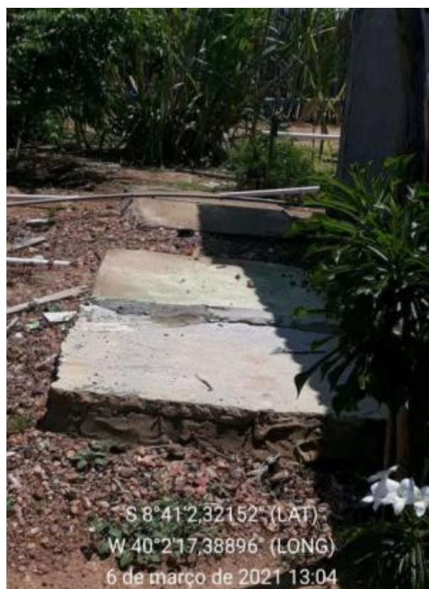
Figura 168 – Cisterna Fonte: INSTITUTO GESOIS, 2021.
