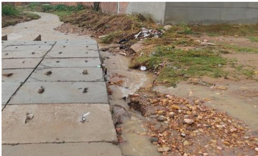
Figura 468 - Formação de processo erosivo Fonte: INSTITUTO GESOIS, 2020.
