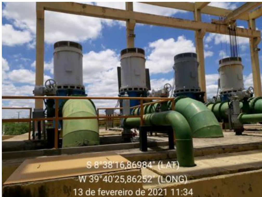
Figura 263 – Bombeamento Fonte: INSTITUTO GESOIS, 2021.
