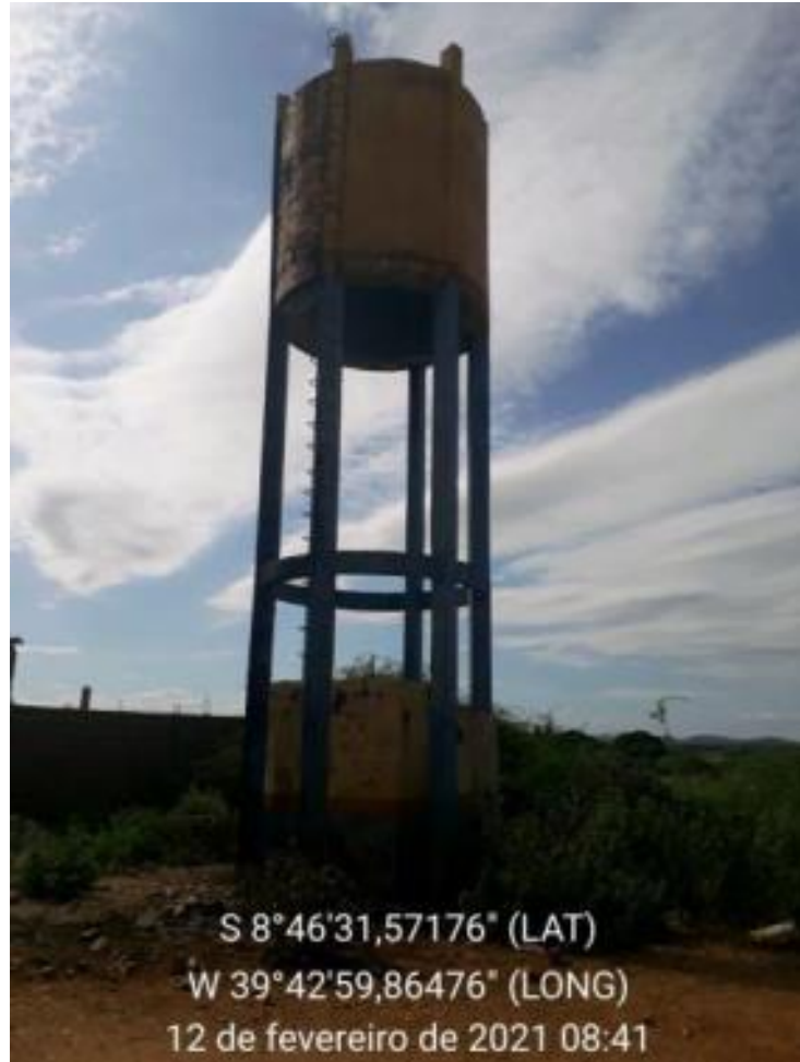
Figura 125 – Reservatório Fonte: INSTITUTO GESOIS, 2021.
