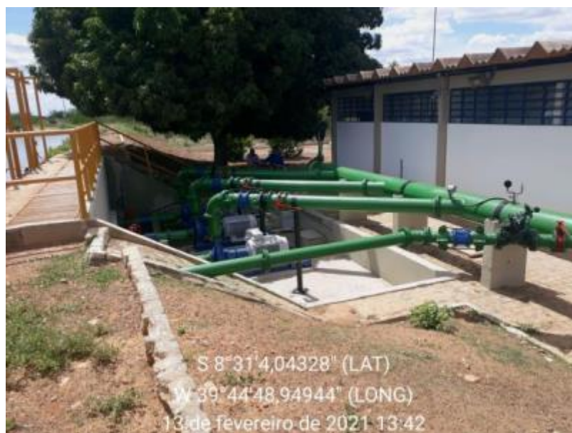
Figura 273 – Tubulações Fonte: INSTITUTO GESOIS, 2021.
