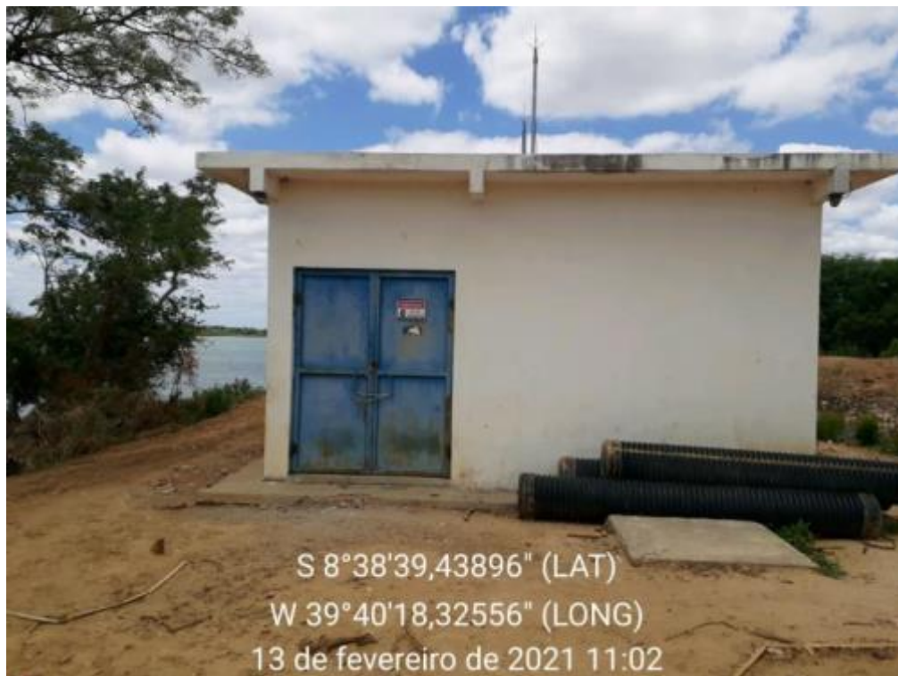
Figura 261 – Casa de Bombas Fonte: INSTITUTO GESOIS, 2021.
