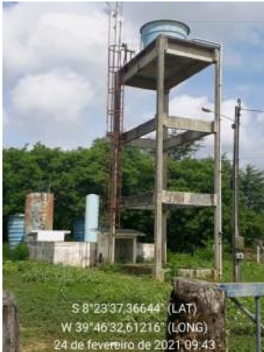
Figura 346 – Reservatório Fonte: INSTITUTO GESOIS, 2021.
