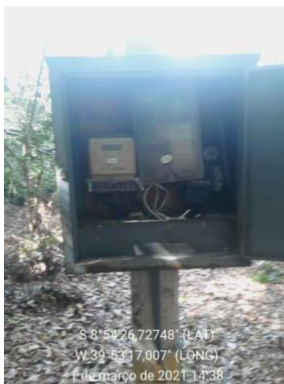
Figura 207 – Painel de Controle Fonte: INSTITUTO GESOIS, 2021.
