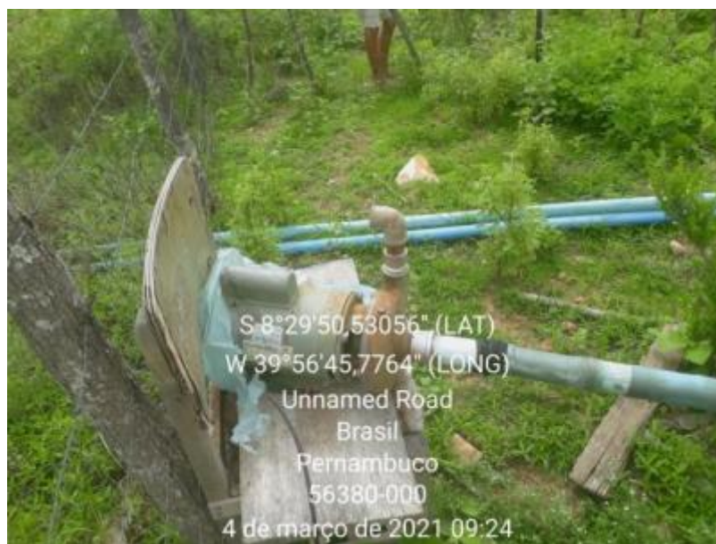
Figura 59 – Sistema de Bombeamento Fonte: INSTITUTO GESOIS, 2021.
