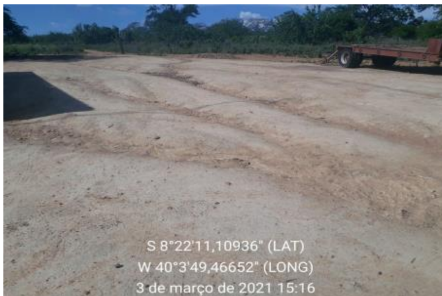
Figura 435 - Vestígios de escoamento superficial e formação de erosão em Fazenda Juá Fonte: INSTITUTO GESOIS, 2020.
