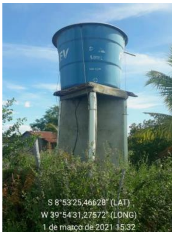
Figura 220 – Reservatório Fonte: INSTITUTO GESOIS, 2021.
