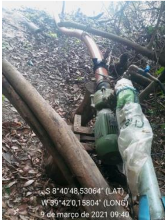
Figura 74 – Sistema de Bombeamento Fonte: INSTITUTO GESOIS, 2021.
