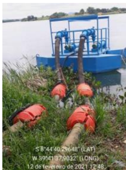
Figura 108 – Captação Serrote(CODEVASF) Fonte: INSTITUTO GESOIS, 2021.
