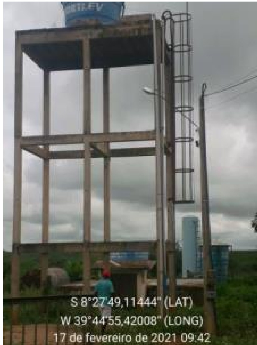
Figura 310 – Reservatório Fonte: INSTITUTO GESOIS, 2021.
