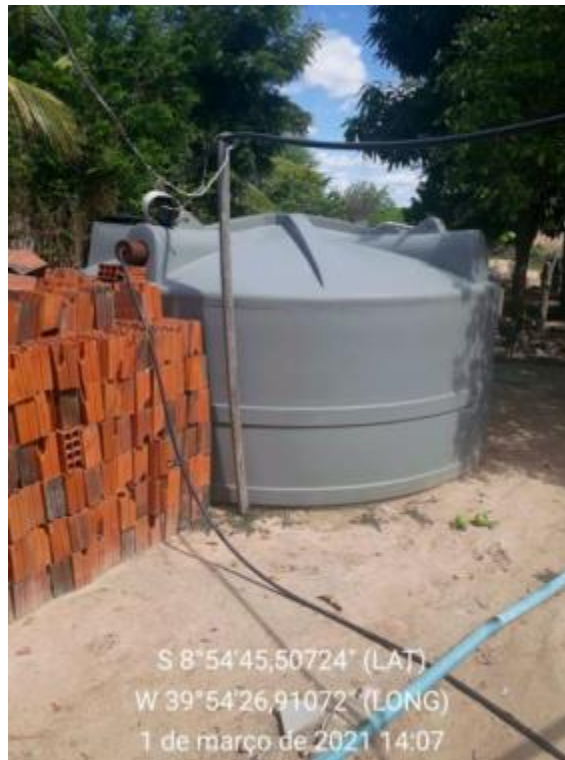
Figura 208 – Cisterna Fonte: INSTITUTO GESOIS, 2021.
