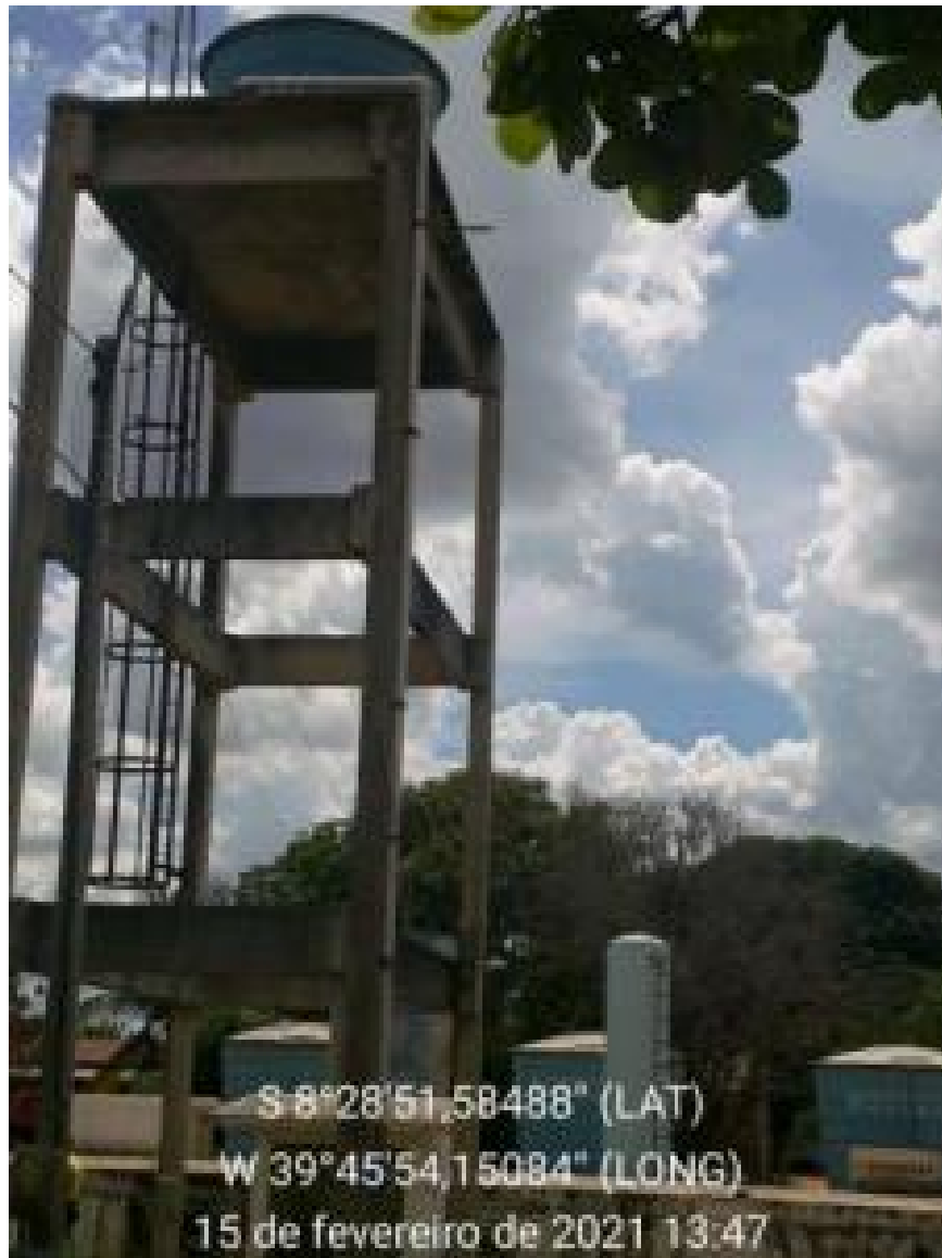
Figura 313 – Reservatório Fonte: INSTITUTO GESOIS, 2021.
