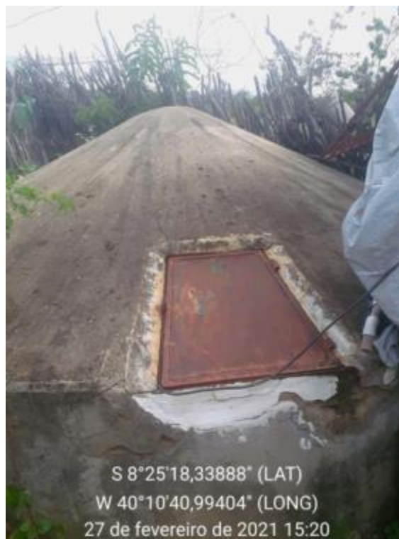
Figura 86 – Cisterna Calçadão Fonte: INSTITUTO GESOIS, 2021.
