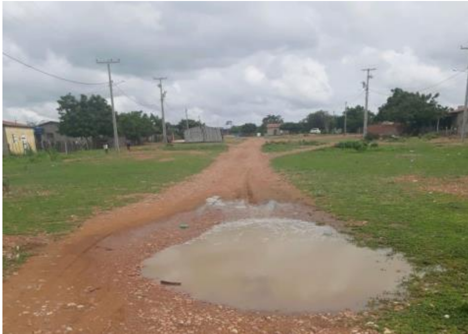
Figura 447 – Poça d’água nas vias do Assentamento APA Fonte: INSTITUTO GESOIS, 2020.
