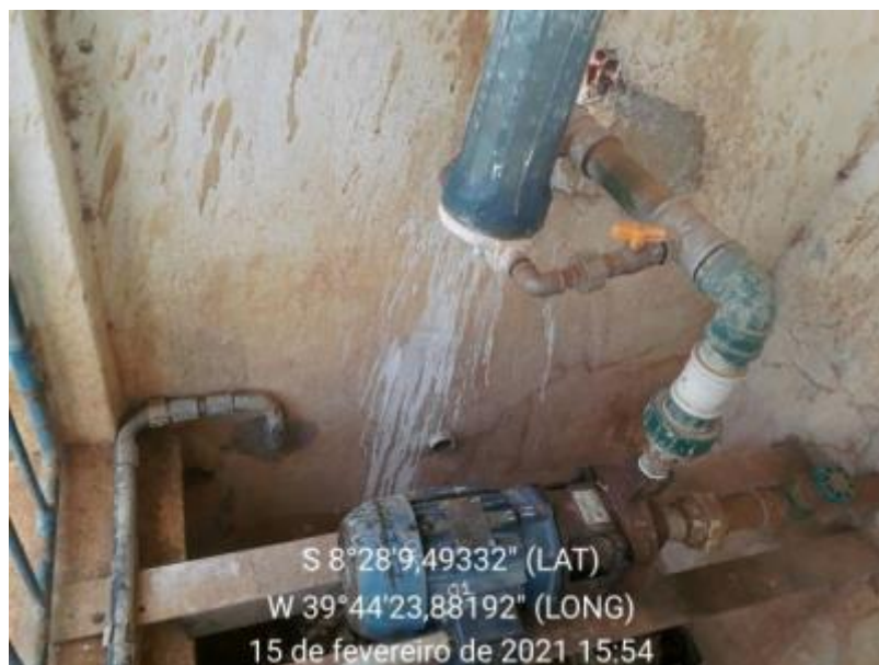
Figura 305 – Bombeamento Fonte: INSTITUTO GESOIS, 2021.
