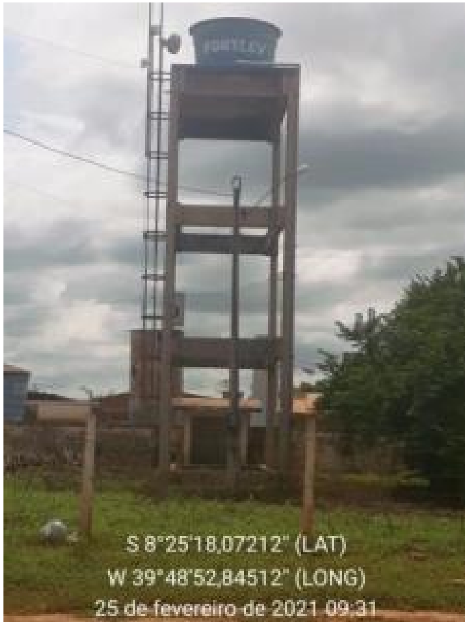
Figura 335 – Reservatório Fonte: INSTITUTO GESOIS, 2021.
