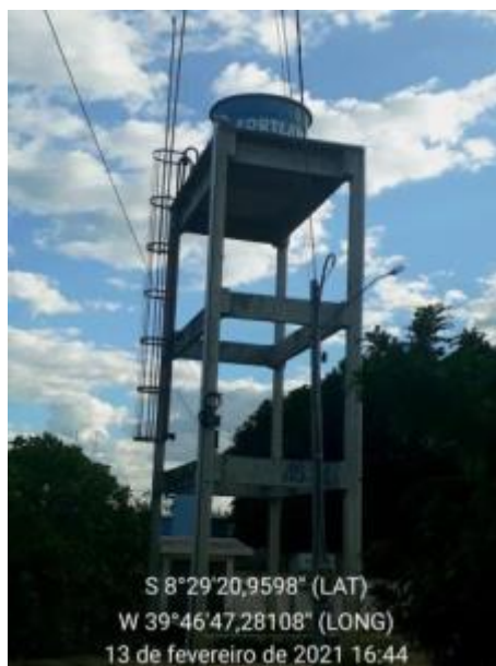
Figura 316 – Reservatório Fonte: INSTITUTO GESOIS, 2021.
