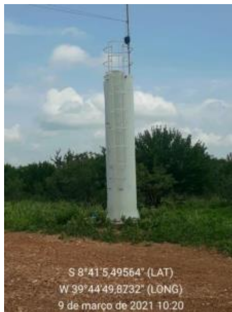
Figura 75 – Reservatório Fonte: INSTITUTO GESOIS, 2021.
