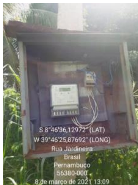
Figura 91 – Medidor e Disjuntor Fonte: INSTITUTO GESOIS, 2021.
