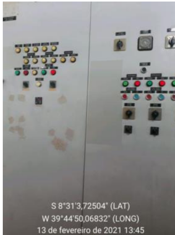
Figura 274 – Painel de Controle Fonte: INSTITUTO GESOIS, 2021.
