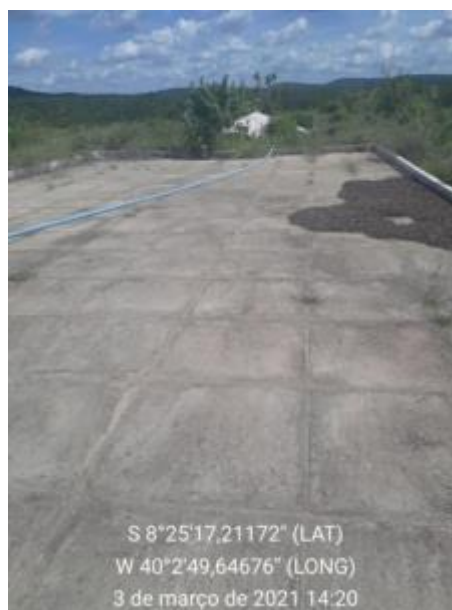
Figura 82 – Cisterna Calçadão Fonte: INSTITUTO GESOIS, 2021.
