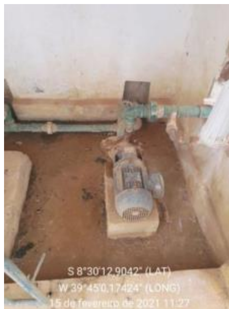
Figura 295 – Bombas Fonte: INSTITUTO GESOIS, 2021.
