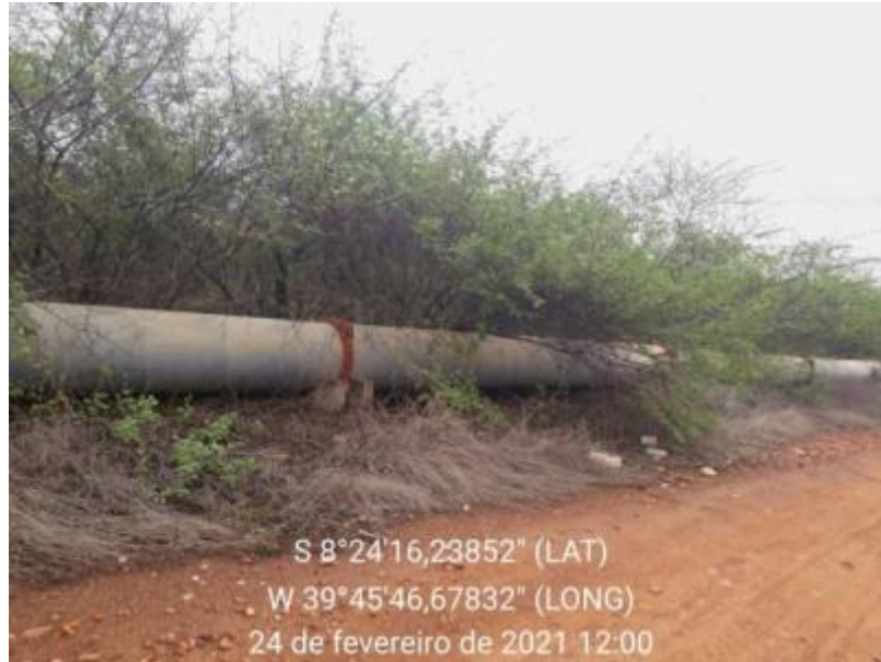
Figura 341 – Tubulação Água, 500 mm, 3,0 km Fonte: INSTITUTO GESOIS, 2021.
