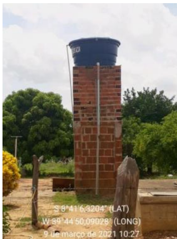
Figura 77 – Reservatório, 500 L Fonte: INSTITUTO GESOIS, 2021.
