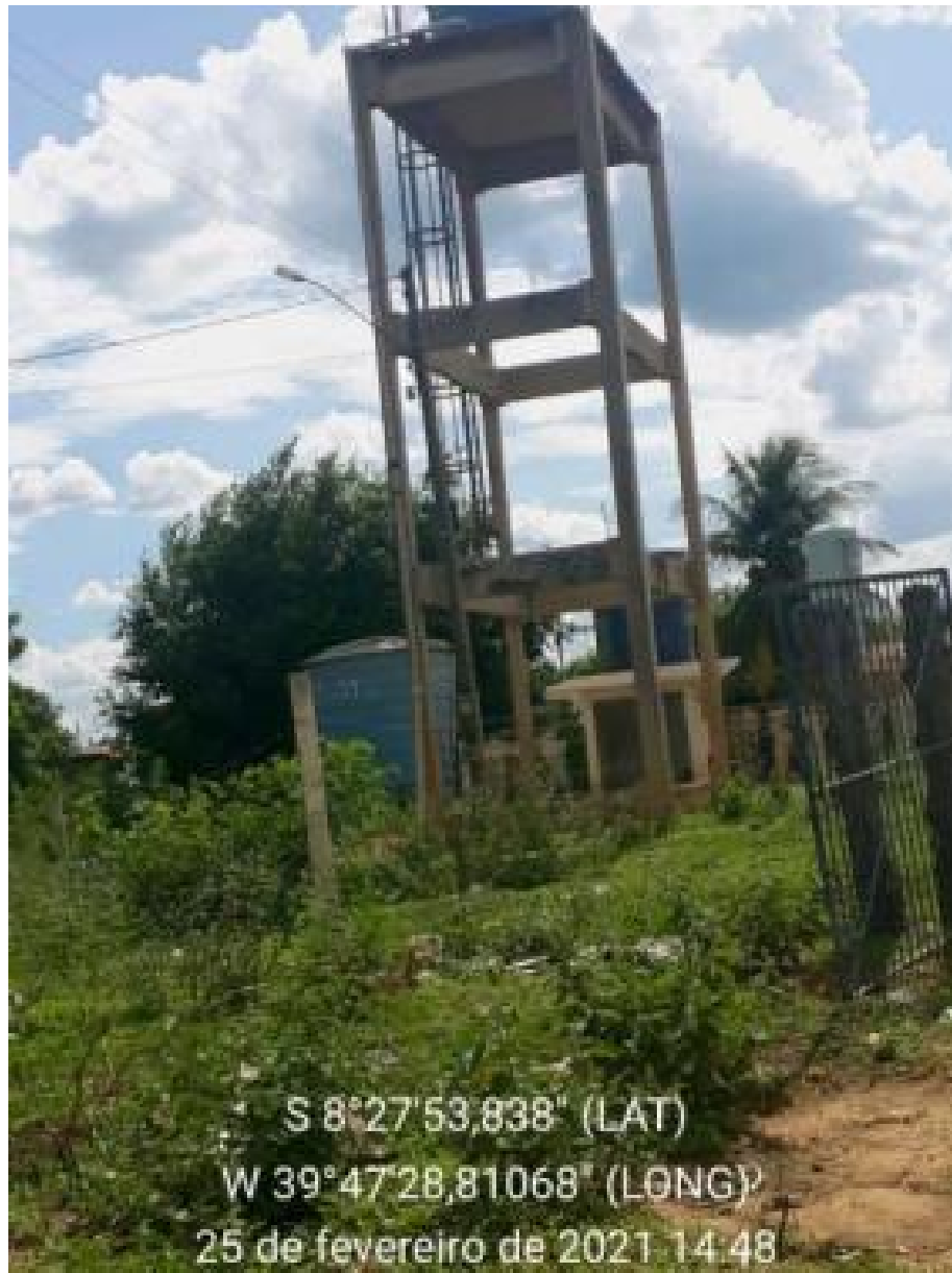
Figura 323 – Reservatório Fonte: INSTITUTO GESOIS, 2021.
