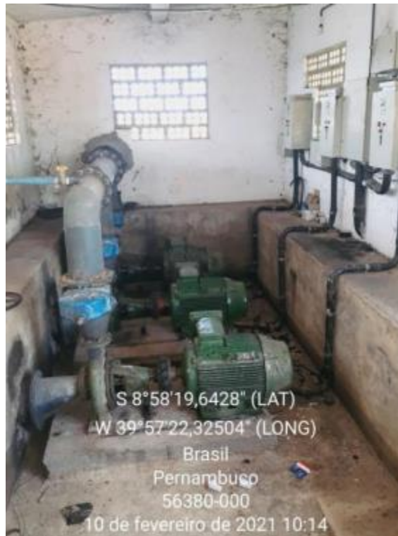
Figura 199 – Sistema de Bombeamento Fonte: INSTITUTO GESOIS, 2021.
