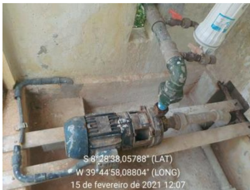
Figura 308 – Bomba Fonte: INSTITUTO GESOIS, 2021.
