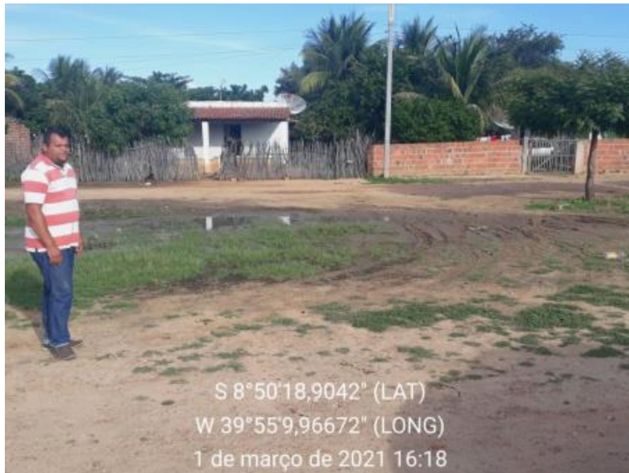
Figura 446 - Ausência de sistema de drenagem no Assentamento Boqueirão Fonte: INSTITUTO GESOIS, 2020.
