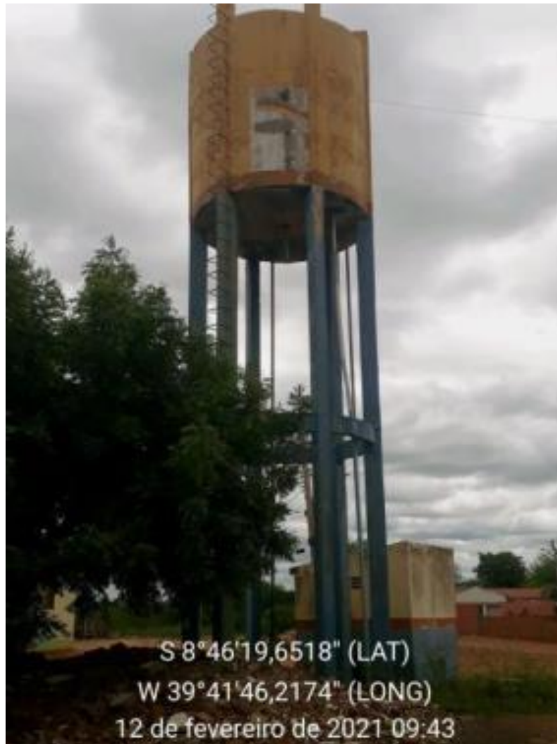
Figura 122 – Reservatório Fonte: INSTITUTO GESOIS, 2021.
