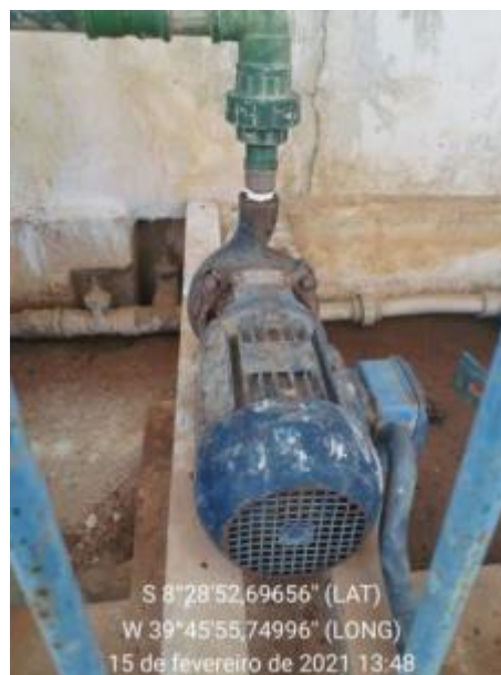
Figura 312 – Bombeamento Fonte: INSTITUTO GESOIS, 2021.
