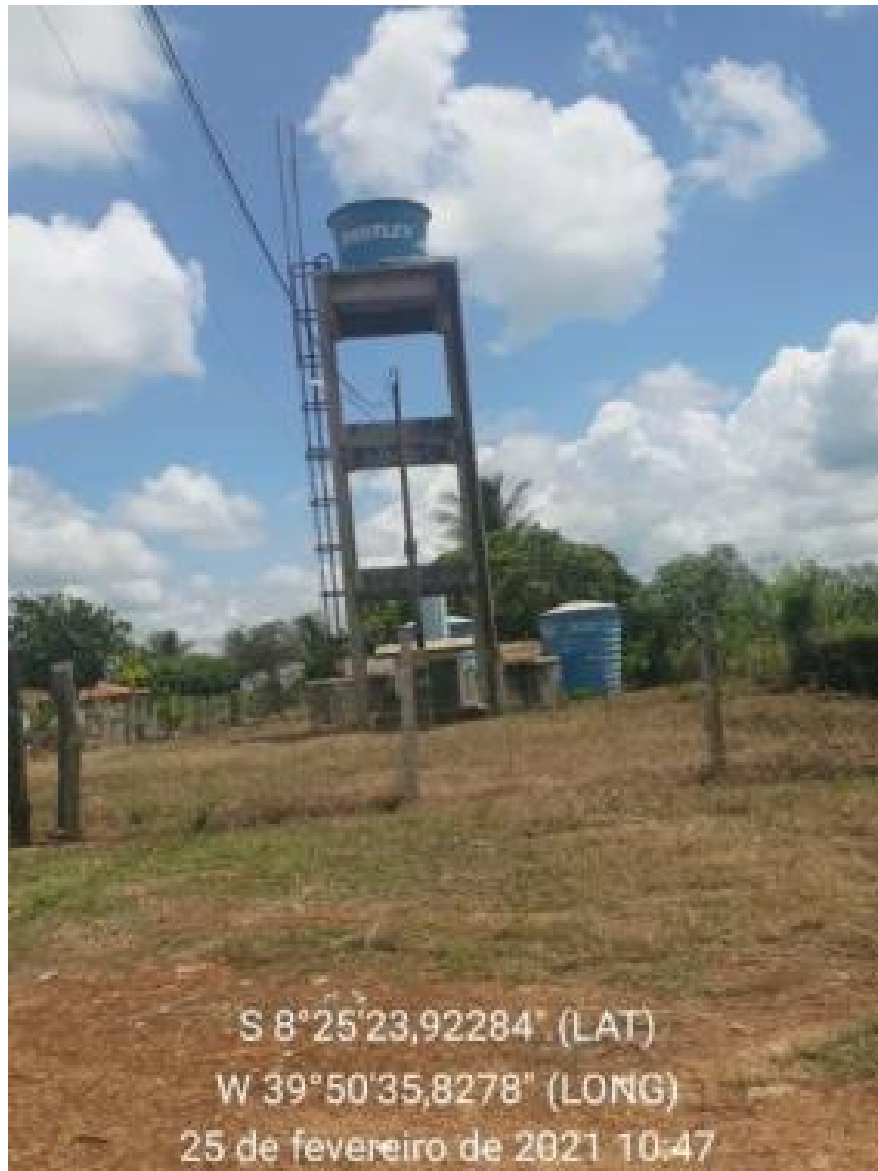
Figura 337 – Reservatório Fonte: INSTITUTO GESOIS, 2021.
