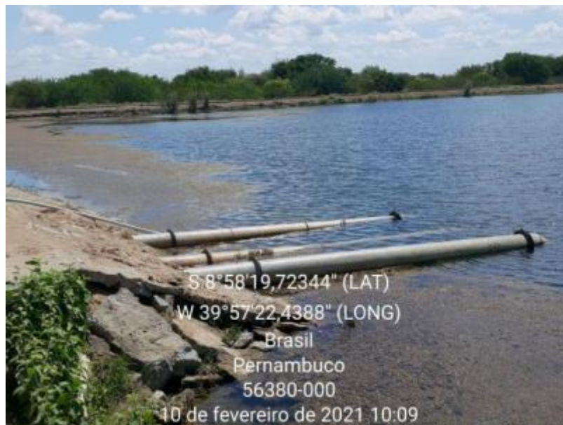
Figura 198 – Reservatório da Adutora Fonte: INSTITUTO GESOIS, 2021.
