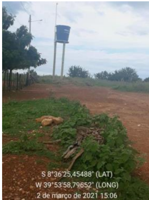
Figura 143 – Sistema Desativado Fonte: INSTITUTO GESOIS, 2021.
