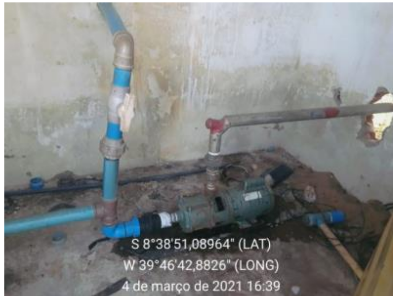
Figura 209 – Sistema de Bombeamento Fonte: INSTITUTO GESOIS, 2021.
