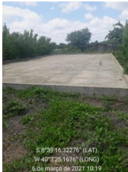
Figura 126 – Cisterna calçadão Fonte: INSTITUTO GESOIS, 2021.
