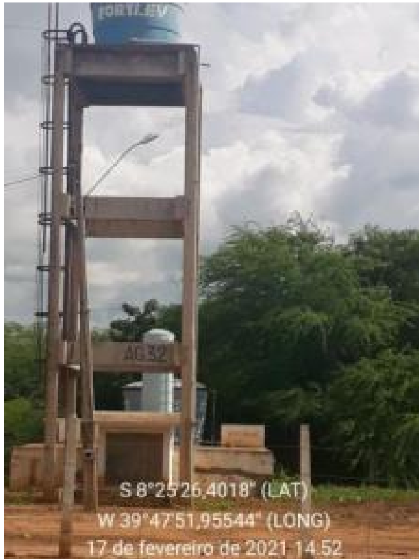
Figura 338 – Reservatório Fonte: INSTITUTO GESOIS, 2021.
