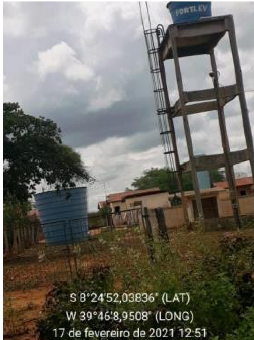
Figura 327 – Reservatório Fonte: INSTITUTO GESOIS, 2021.
