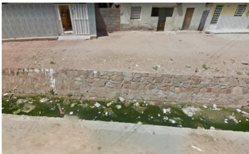
Figura 426 - Canal de macrodrenagem passando pela Rua da Floresta Fonte: INSTITUTO GESOIS, 2020.
