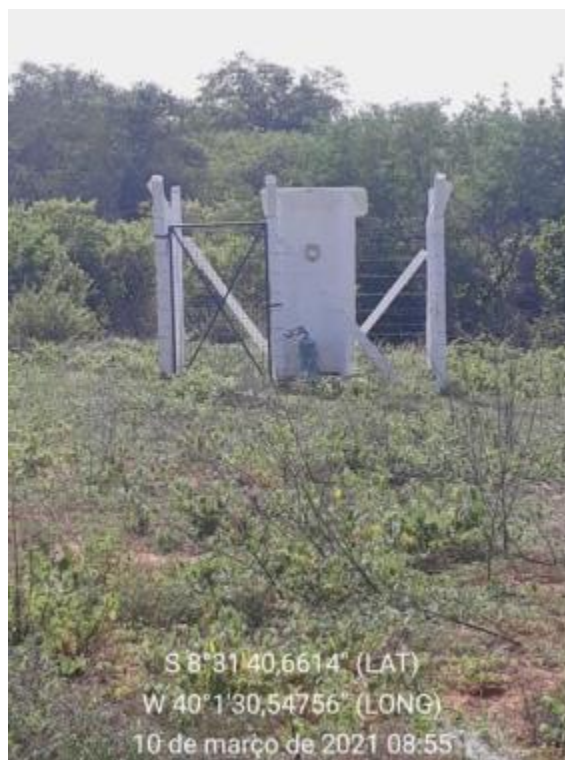
Figura 52 – Sistema de Eletrificação do Poço Fonte: INSTITUTO GESOIS, 2021.
