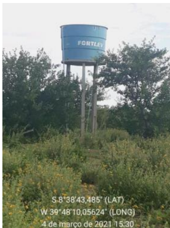
Figura 44 – Reservatório 10.000 litros Fonte: INSTITUTO GESOIS, 2021.
