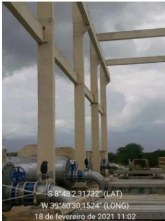
Figura 32 – Captação do Garças Fonte: INSTITUTO GESOIS, 2021.
