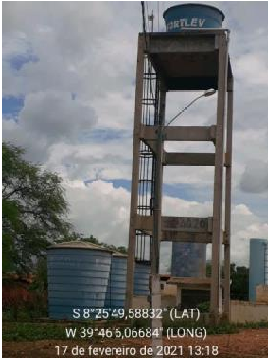
Figura 326 – Reservatório Fonte: INSTITUTO GESOIS, 2021.
