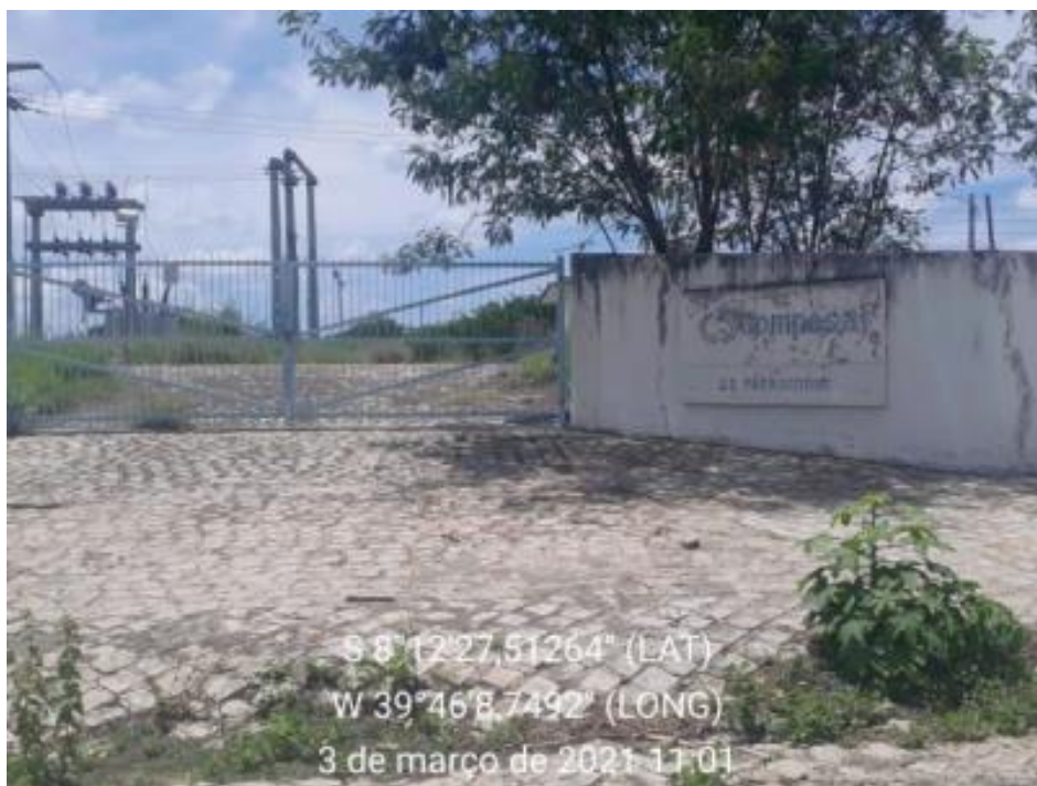
Figura 39 – Subestação da Adutora do Oeste, Parnamirim Fonte: INSTITUTO GESOIS, 2021.
