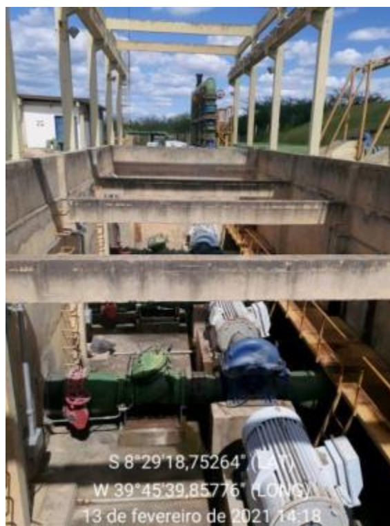
Figura 279 – Estação de Bombeamento II Fonte: INSTITUTO GESOIS, 2021.
