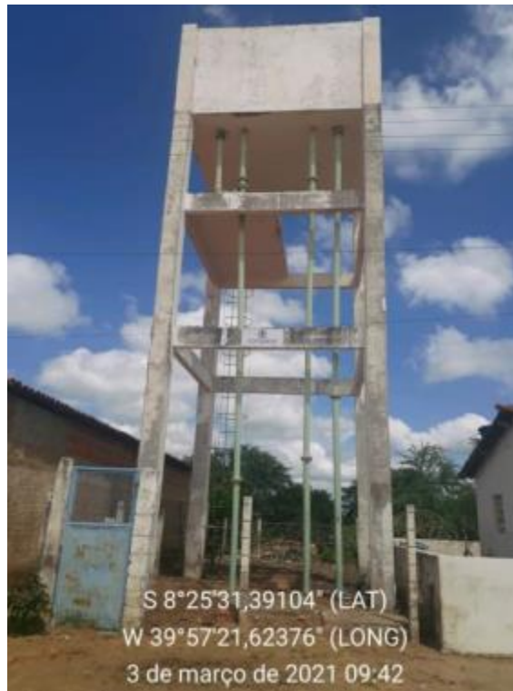
Figura 42 – Reservatório, 10.000 litros Fonte: INSTITUTO GESOIS, 2021.
