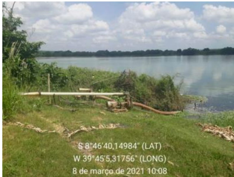
Figura 242 – Captação Fonte: INSTITUTO GESOIS, 2021.
