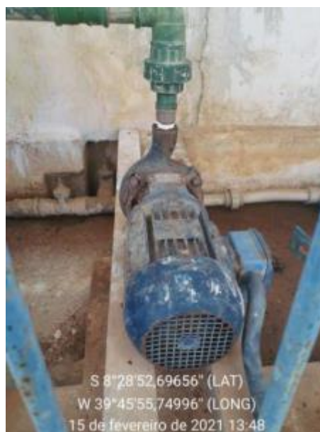
Figura 302 – Bombas Fonte: INSTITUTO GESOIS, 2021.
