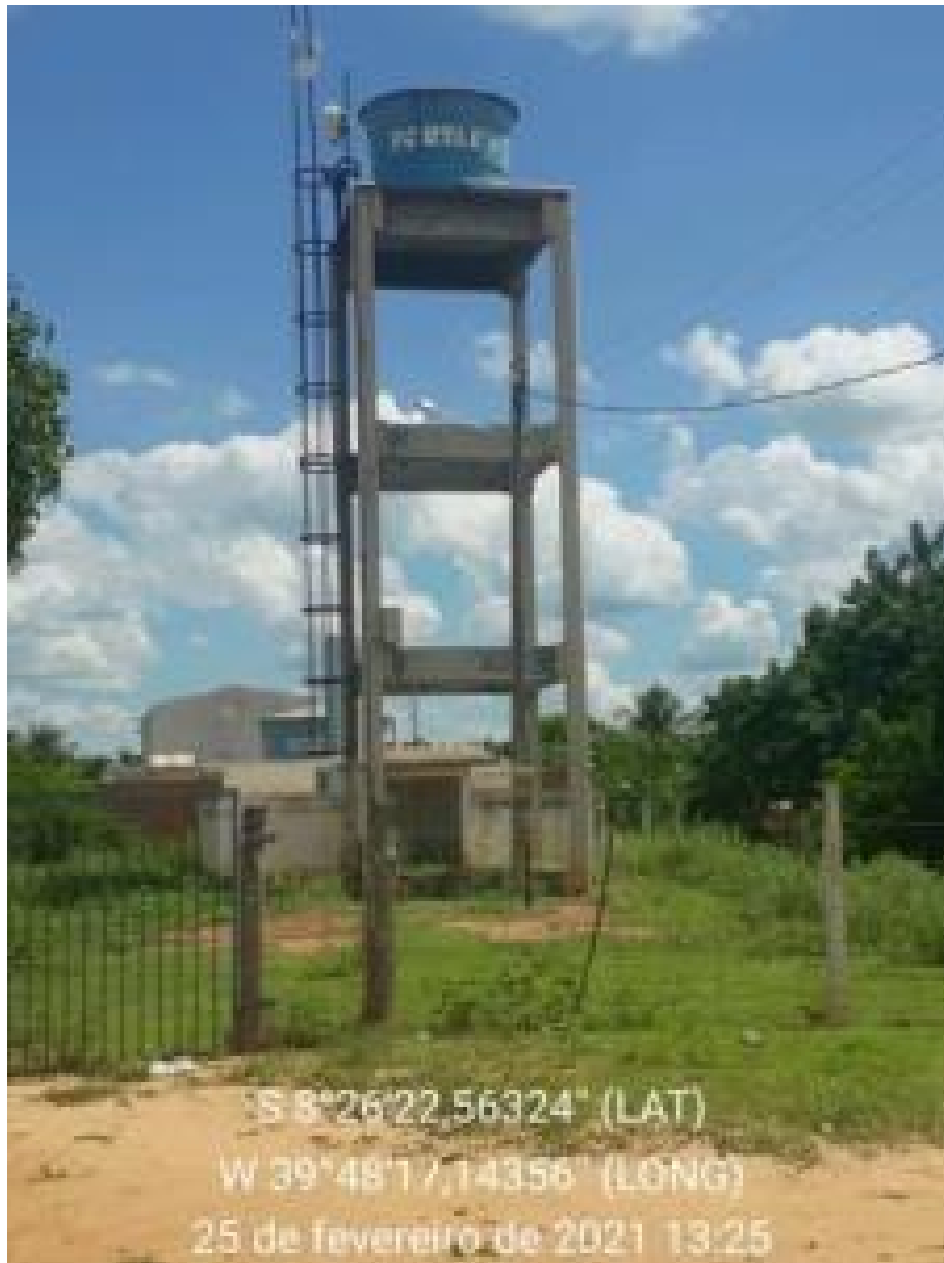
Figura 329 – Reservatório Fonte: INSTITUTO GESOIS, 2021.
