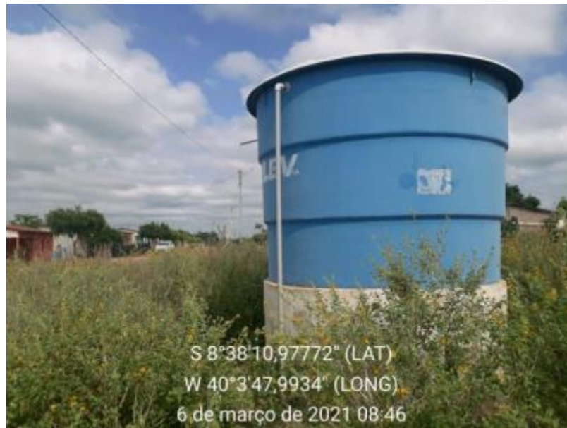
Figura 155 – Poço, Reservatório 10.000 L Fonte: INSTITUTO GESOIS, 2021.
