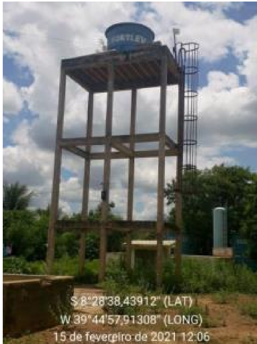
Figura 309 – Reservatório Fonte: INSTITUTO GESOIS, 2021.
