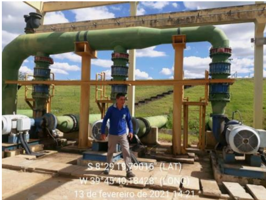
Figura 280 – Estação de Bombeamento III Fonte: INSTITUTO GESOIS, 2021.
