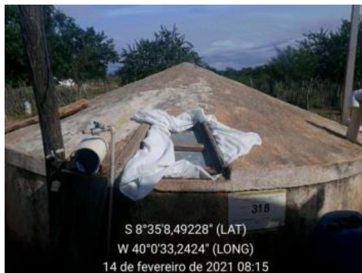
Figura 116 – Cisterna Fonte: INSTITUTO GESOIS, 2021.
