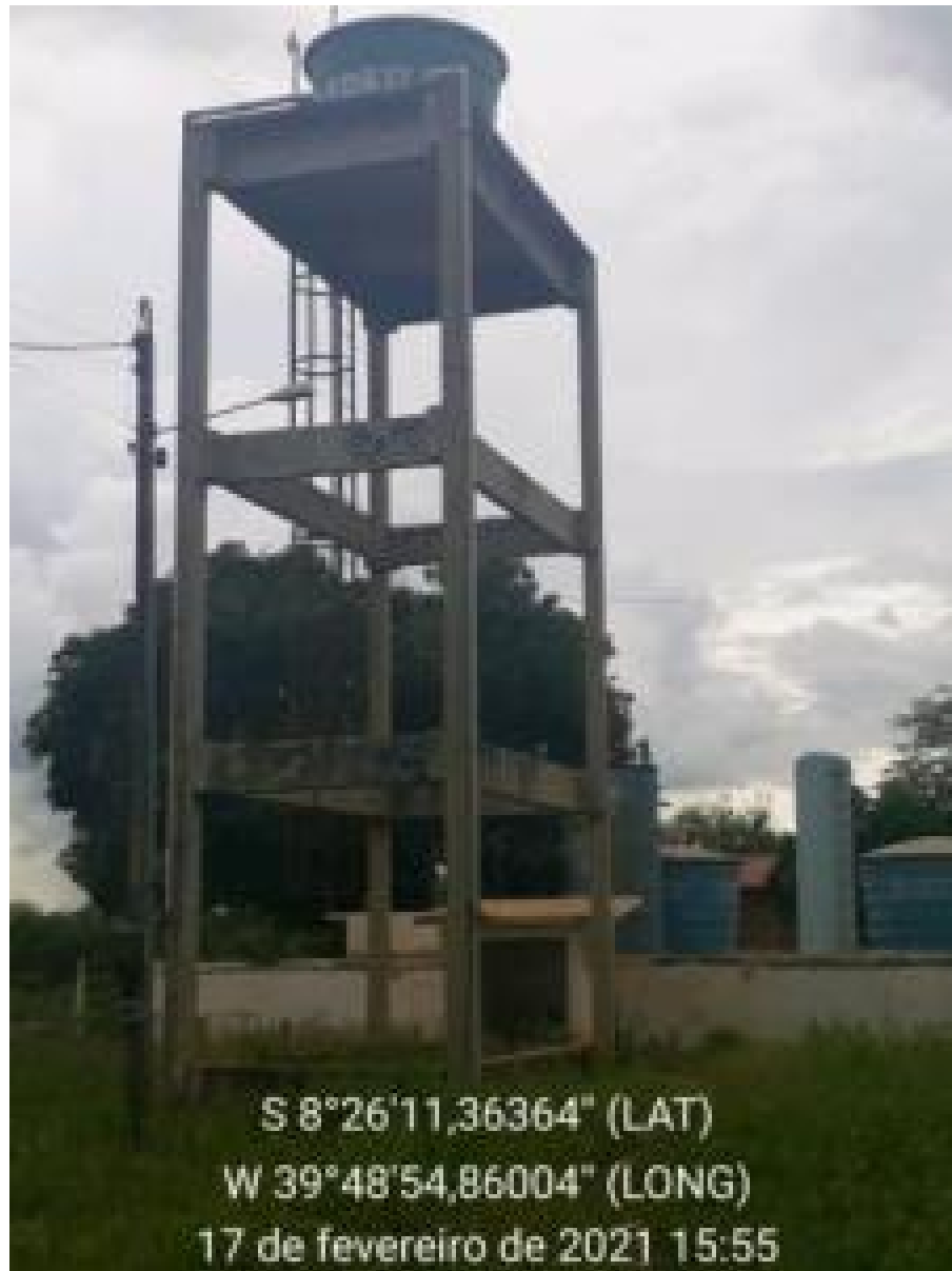
Figura 331 – Reservatório Fonte: INSTITUTO GESOIS, 2021.
