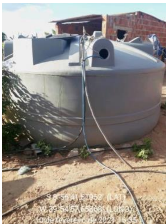
Figura 205 – Cisterna Fonte: INSTITUTO GESOIS, 2021.
