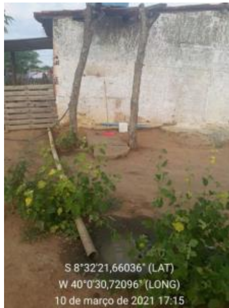
Figura 358 – Esgoto a céu aberto na Faz. Jardim Fonte: INSTITUTO GESOIS, 2021.
