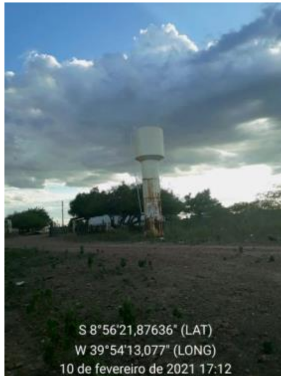
Figura 187 – Sistema Desativado Fonte: INSTITUTO GESOIS, 2021.
