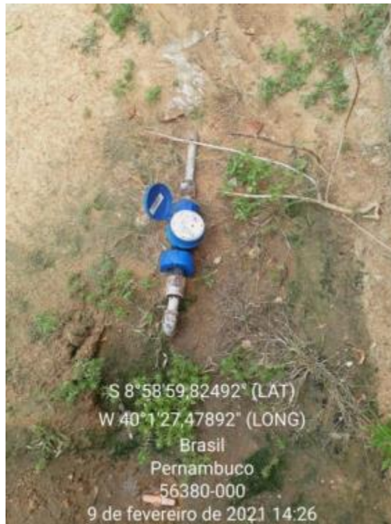
Figura 180 – Hidrômetro Fonte: INSTITUTO GESOIS, 2021.
