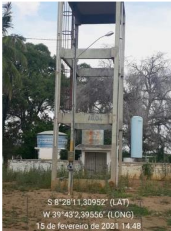
Figura 298 – Elevatória Fonte: INSTITUTO GESOIS, 2021.
