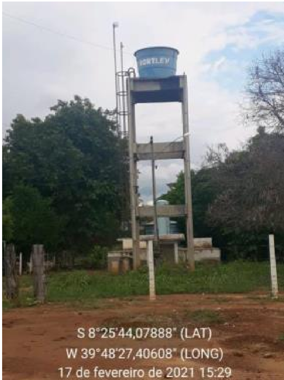
Figura 330 – Reservatório Fonte: INSTITUTO GESOIS, 2021.
