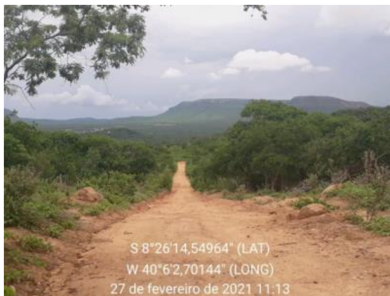
Figura 80 – Acesso em Más Condições Fonte: INSTITUTO GESOIS, 2021.
