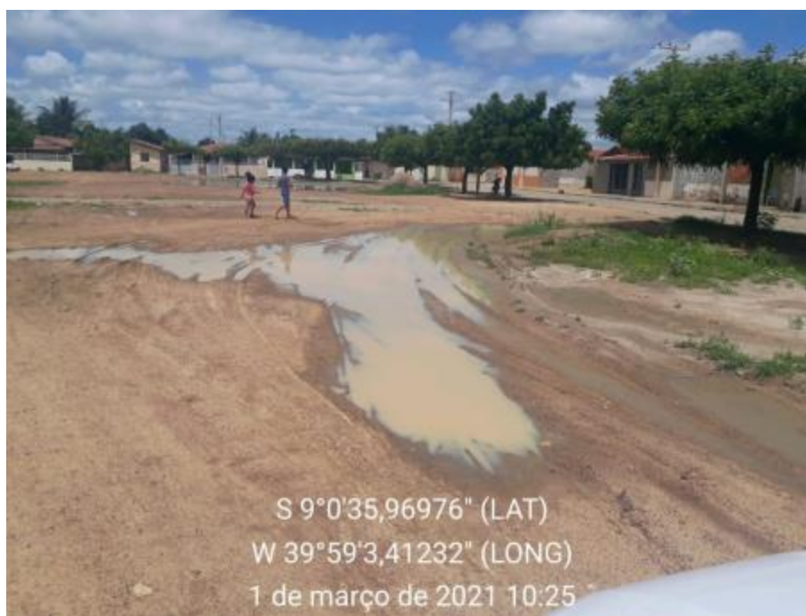
Figura 433 - Acúmulo de água em Fazenda Milano pela falta de drenagem Fonte: INSTITUTO GESOIS, 2020.
