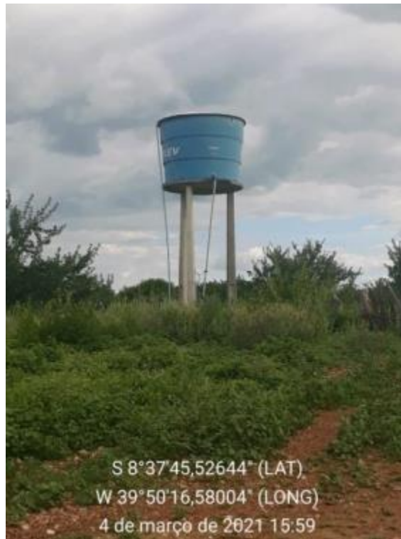
Figura 211 – Reservatório Fonte: INSTITUTO GESOIS, 2021.
