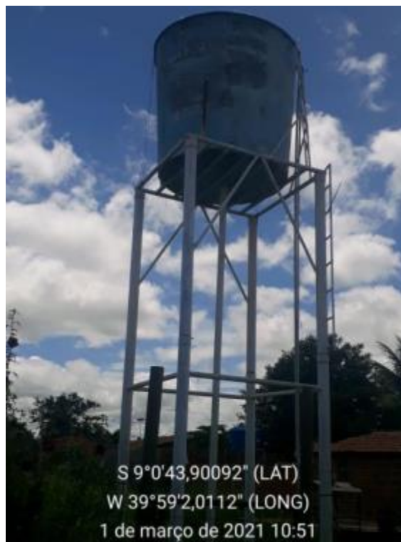
Figura 236 – Reservatório 10.000 L Fonte: INSTITUTO GESOIS, 2021.
