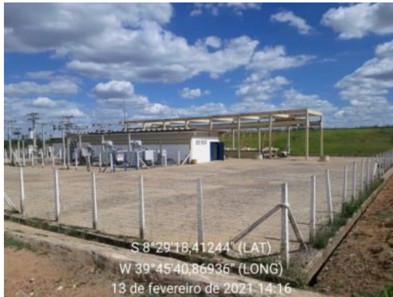
Figura 278 – Estação de Bombeamento II e III Fonte: INSTITUTO GESOIS, 2021.
