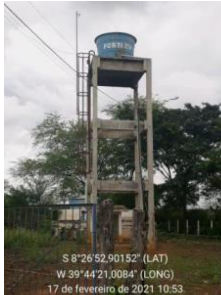
Figura 319 – Reservatório Fonte: INSTITUTO GESOIS, 2021.
