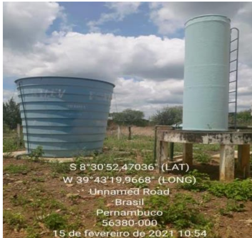
Figura 264 – Reservatórios Fonte: INSTITUTO GESOIS, 2021.
