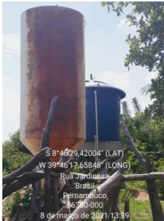
Figura 92 – Reservatórios Fonte: INSTITUTO GESOIS, 2021.
