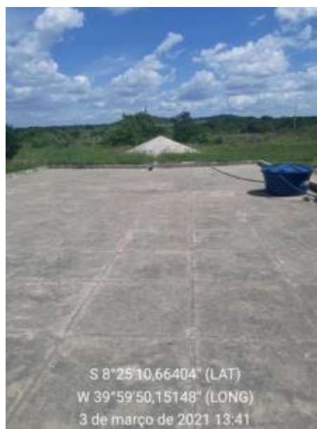
Figura 65 – Cisterna Calçadão, 50.000 L Fonte: INSTITUTO GESOIS, 2021.
