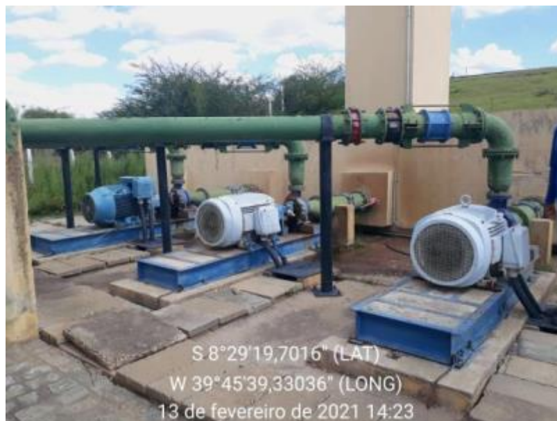
Figura 281 – Estação de Bombeamento II Fonte: INSTITUTO GESOIS, 2021.
