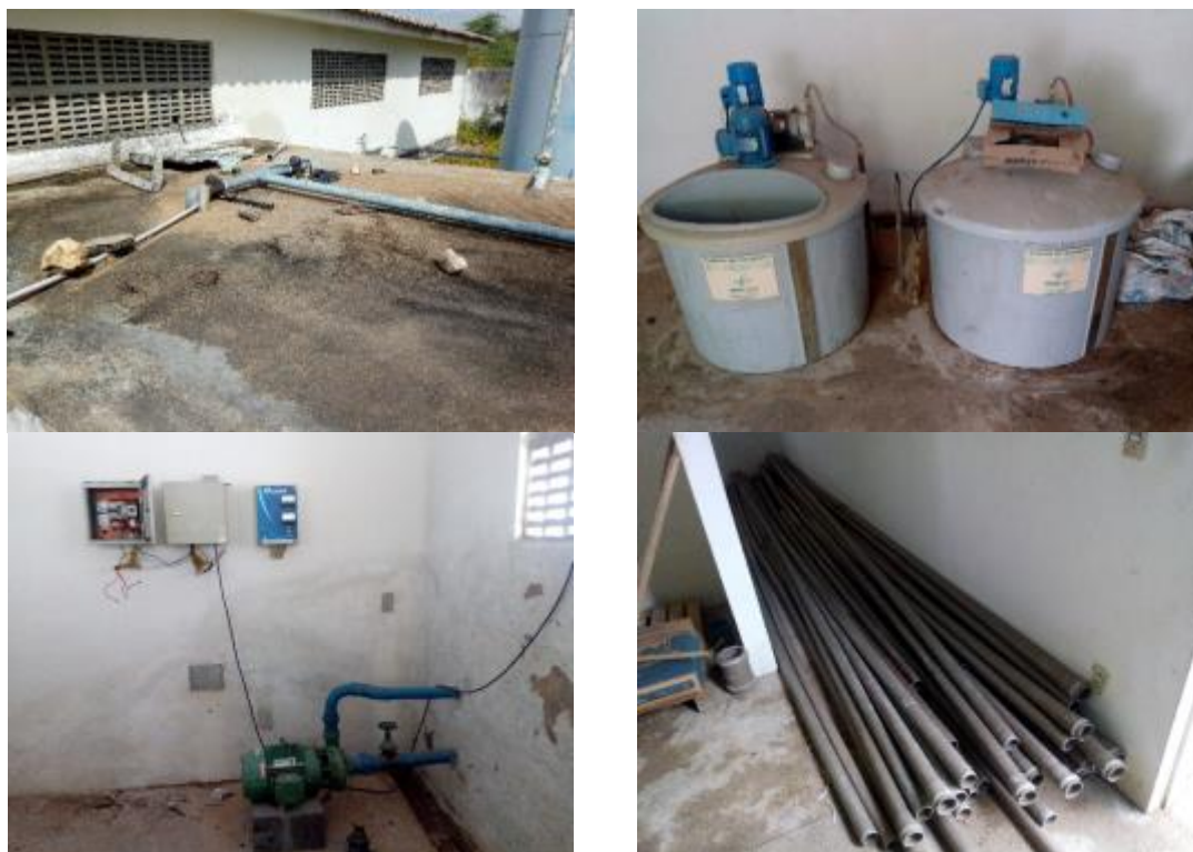
Figura 129 – ETA Desativada na Aldeia Caldeirão Fonte: INSTITUTO GESOIS, 2021.
