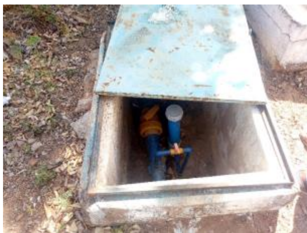
Figura 119 – Caixa da ETA SESAI Desativada na Aldeia Bem Querer de Cima Fonte: INSTITUTO GESOIS, 2021.
