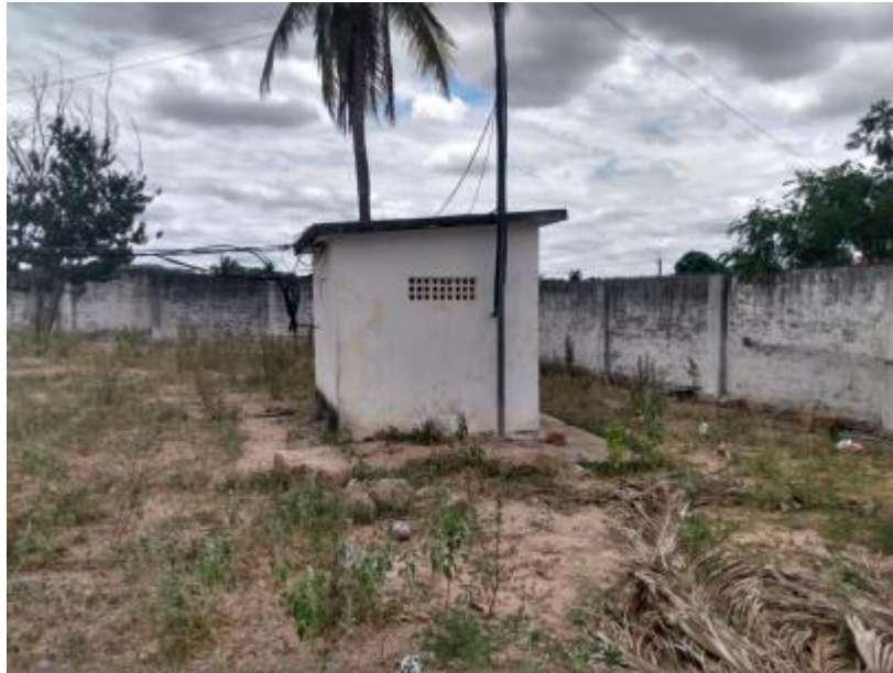
Figura 71 – Reservatório Inoperante da Volta do Moxotó Fonte: INSTITUTO GESOIS, 2021.
