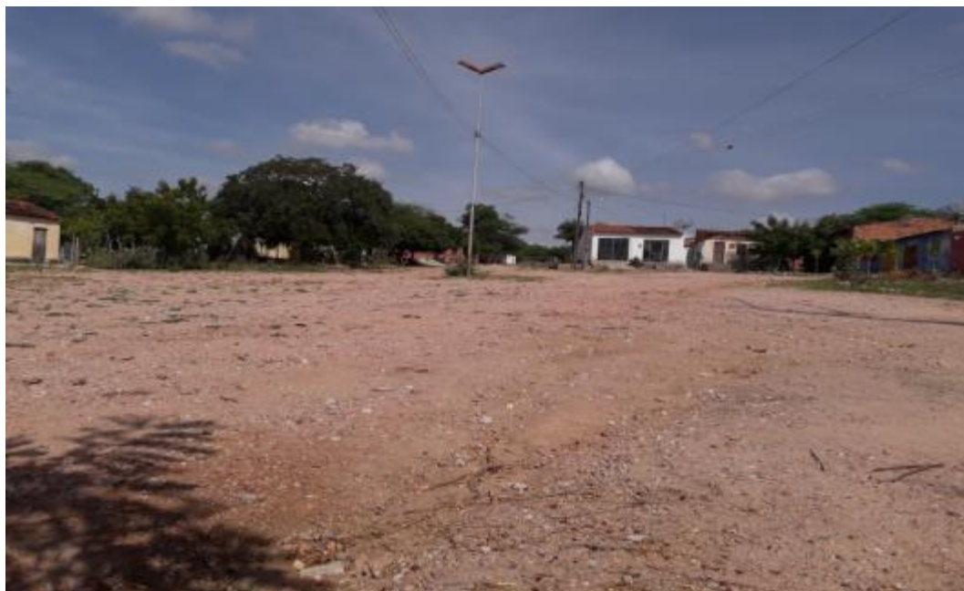
Figura 363 – Ausência de Pavimentação e Sistema de Drenagem na Localidade Canafístula
