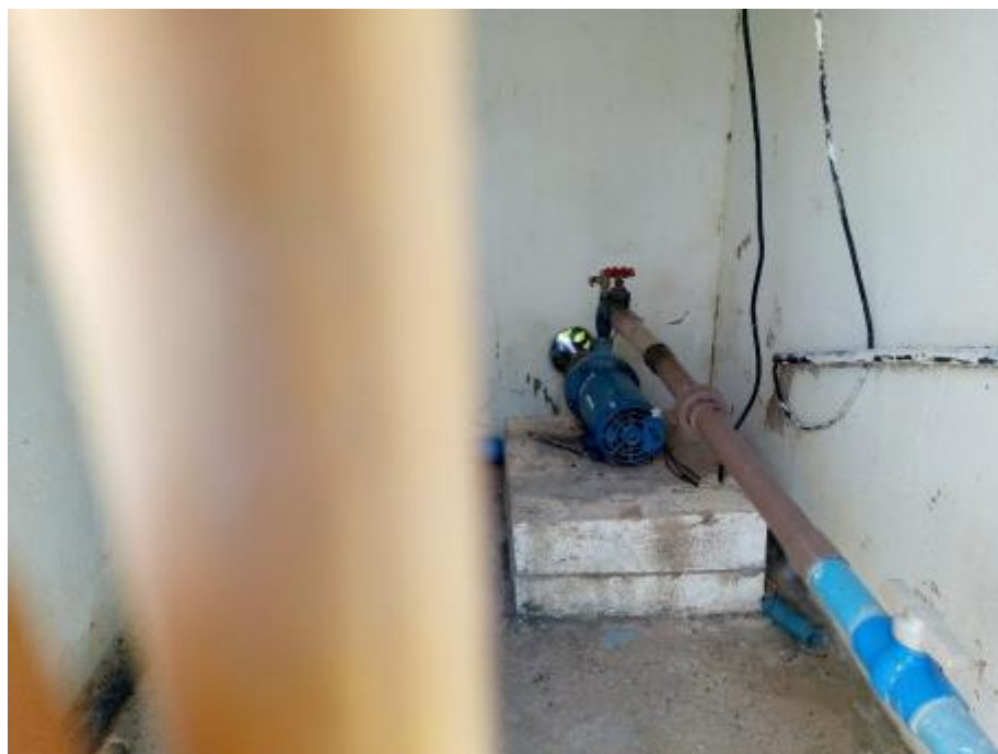
Figura 161 – Instalação da Bomba da Captação Fonte: INSTITUTO GESOIS, 2021.
