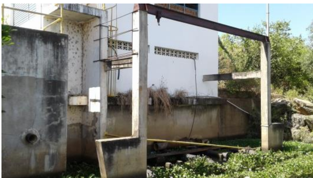
Figura 28 – Captação COMPESA Fonte: INSTITUTO GESOIS, 2021.
