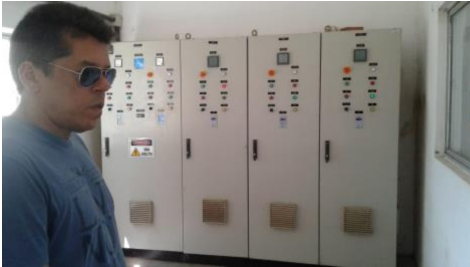
Figura 39 – ETA, Quadros de Comando de Motores Fonte: INSTITUTO GESOIS, 2021.
