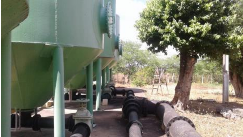
Figura 31 – ETA, filtros Fonte: INSTITUTO GESOIS, 2021.
