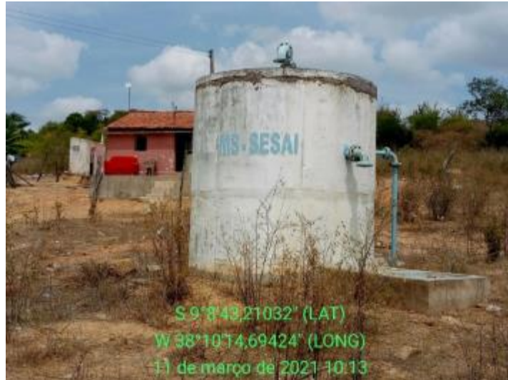
Figura 138 – Caixa D'água Reguladora de Pressão (Caixa Deslizante) Fonte: INSTITUTO GESOIS, 2021.
