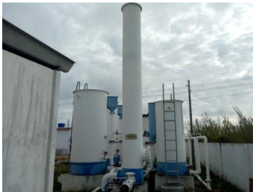
Figura 63 – ETA na Localidade Volta do Moxotó Fonte: INSTITUTO GESOIS, 2021.
