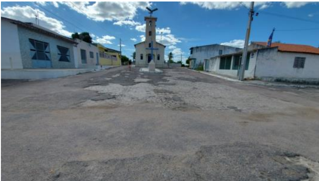
Figura 343 – Aspecto da Pavimentação nas Vias Centrais de Volta do Moxotó Fonte: INSTITUTO GESOIS, 2020.
