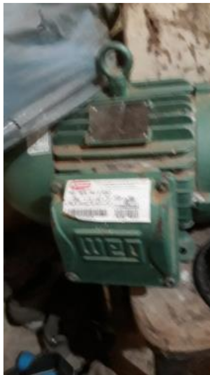
Figura 152 – Bomba D'água Fazenda Grande Fonte: INSTITUTO GESOIS, 2021.
