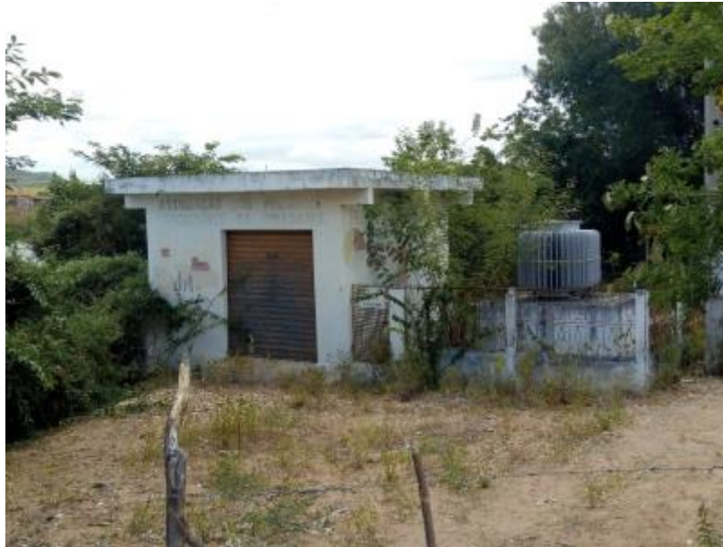
Figura 146 – Captação Inoperante do Assentamento Cidadania Fonte: INSTITUTO GESOIS, 2021.
