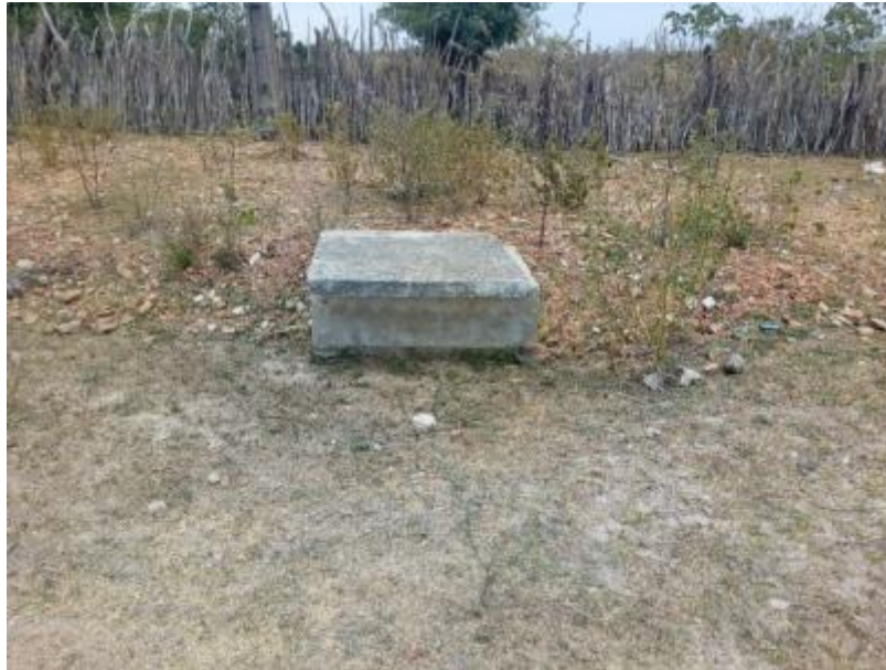
Figura 208 – Estrutura de SAA CODEVASF Desativado Fonte: INSTITUTO GESOIS, 2021.
