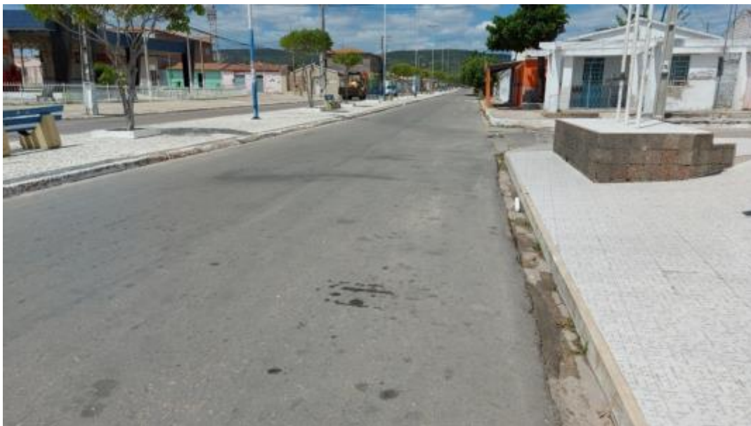
Figura 309 – Detalhe da Via sem Presença de Sarjeta Fonte: INSTITUTO GESOIS, 2020.
