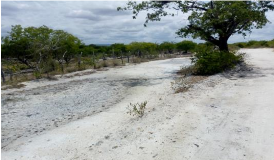
Figura 355 – Indícios de Alagamento na Via por Falta de Sistema de Drenagem na Localidade Martelo
