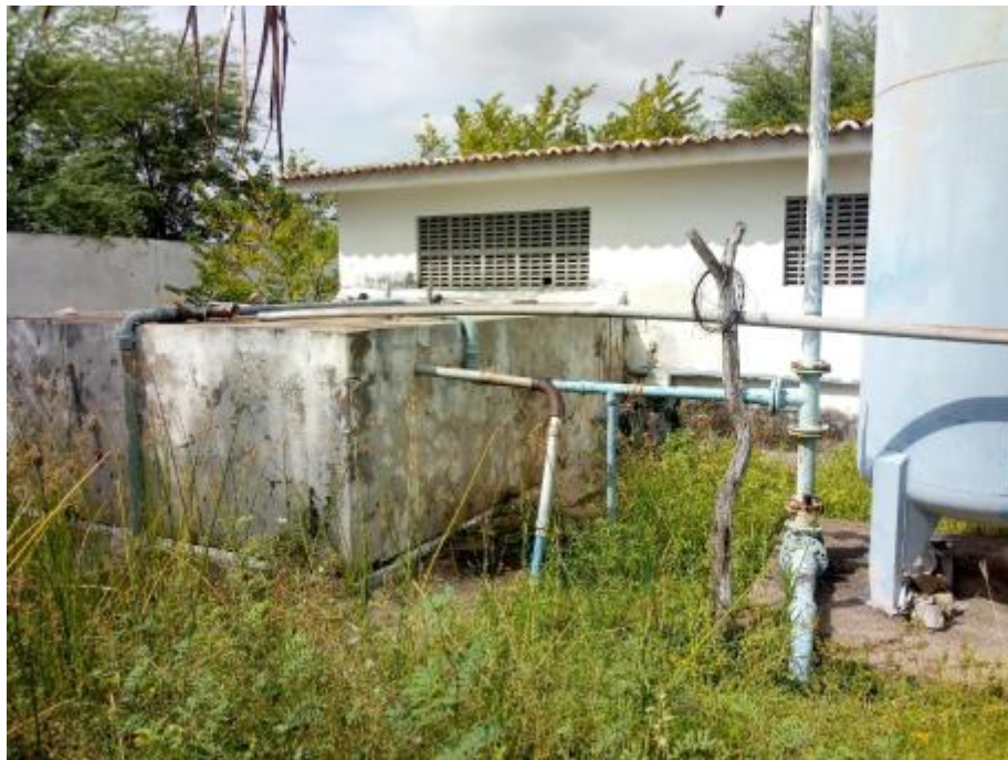
Figura 126 – Cisterna da ETA na Aldeia Caldeirão Fonte: INSTITUTO GESOIS, 2021.
