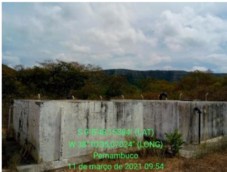
Figura 137 – Reservatórios no Alto da Serra Fonte: INSTITUTO GESOIS, 2021.
