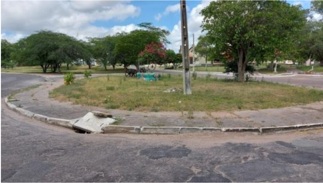
Figura 329 – Boca de Lobo Danificada (Bairro Itaparica) Fonte: INSTITUTO GESOIS, 2020.
