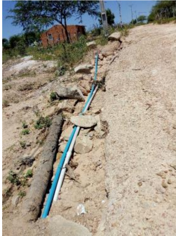
Figura 84 – Tubulação Exposta Devido às Chuvas na Aldeia Pankaiwká Fonte: INSTITUTO GESOIS, 2021.
