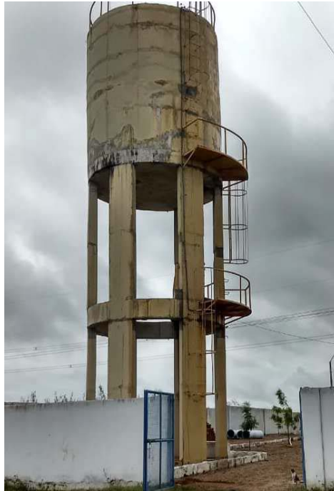
Figura 52 – ETA, COMPESA, Reservatório de Lavagem dos filtros, do Distrito Volta do Moxotó Fonte: COMPESA, 2021.
