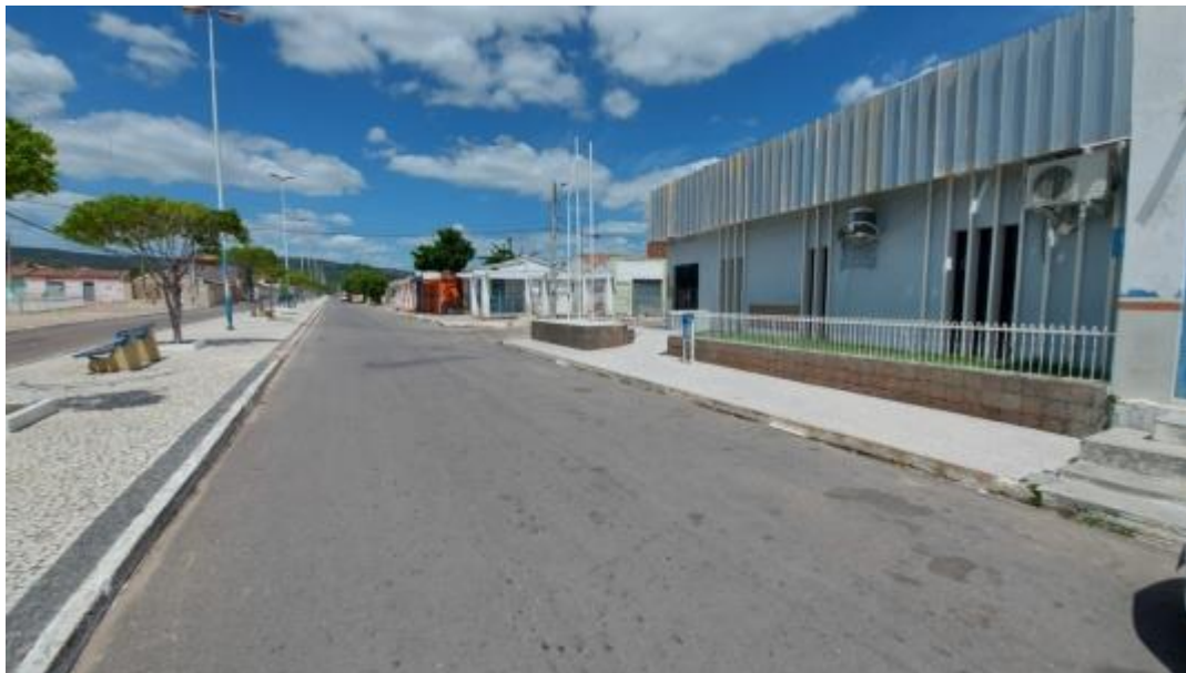
Figura 308 – Via da Sede com Ausência de Sarjeta Fonte: INSTITUTO GESOIS, 2020.
