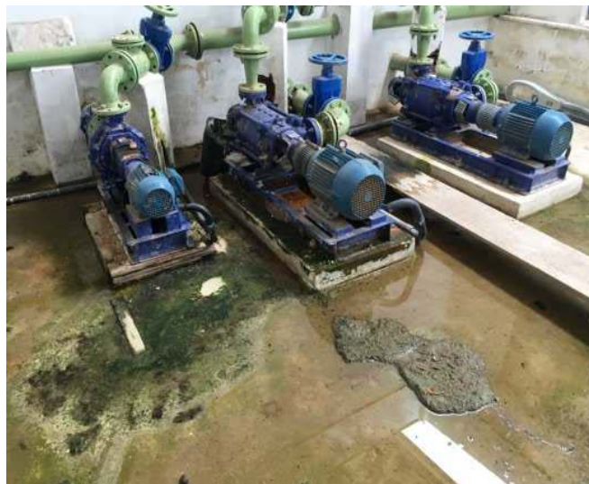
Figura 53 – Conjunto Moto-bomba EEAT do Distrito Volta do Moxotó Fonte: COMPESA, 2021.
