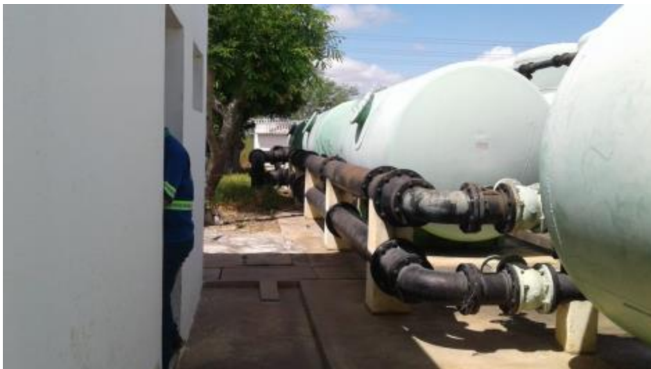
Figura 32 – ETA Fonte: INSTITUTO GESOIS, 2021.
