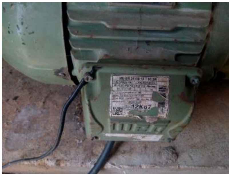
Figura 203 – Bomba da Captação Fonte: INSTITUTO GESOIS, 2021.
