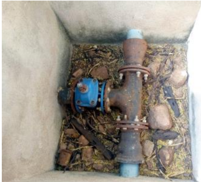
Figura 189 – Estrutura do SAA CODEVASF Inacabado Fonte: INSTITUTO GESOIS, 2021.
