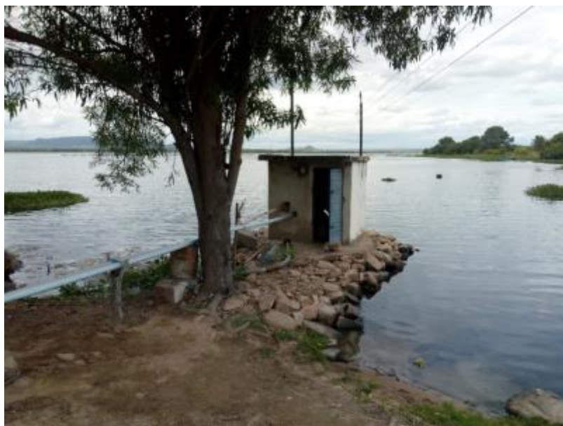
Figura 177 – Captação Fonte: INSTITUTO GESOIS, 2021.
