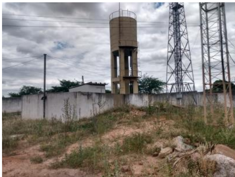
Figura 80 – Caixa D'água Inoperante da Localidade Volta do Moxotó Fonte: INSTITUTO GESOIS, 2021.
