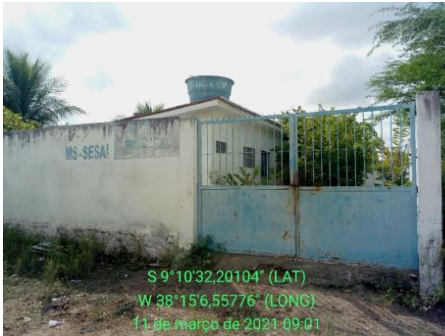
Figura 127 – ETA Desativada na Aldeia Caldeirão Fonte: INSTITUTO GESOIS, 2021.
