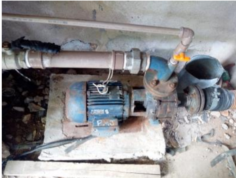
Figura 184 – Bomba da Captação Fonte: INSTITUTO GESOIS, 2021.
