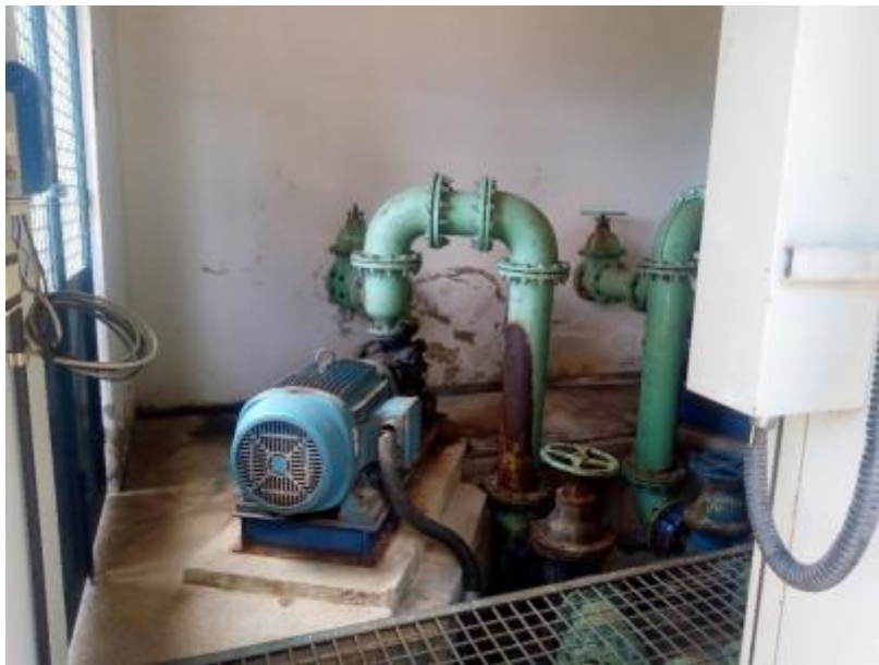
Figura 97 – Bombas da EEAT 1 Fonte: INSTITUTO GESOIS, 2021.
