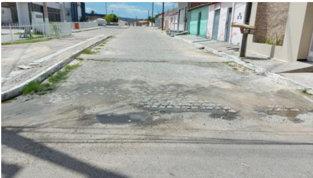
Figura 314 – Detalhe de Água Acumulada na Via Fonte: INSTITUTO GESOIS, 2020.
