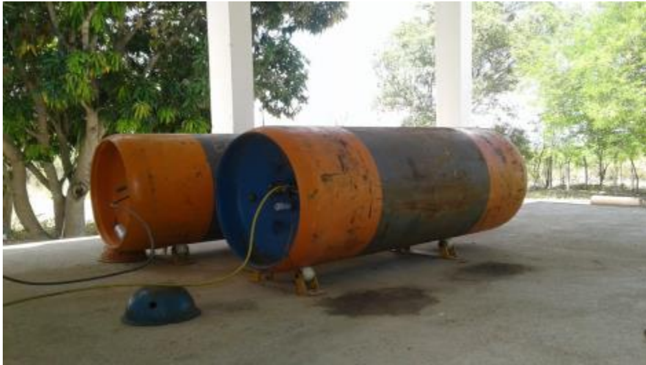
Figura 35 – ETA, Cilindros de Cloro Fonte: INSTITUTO GESOIS, 2021.
