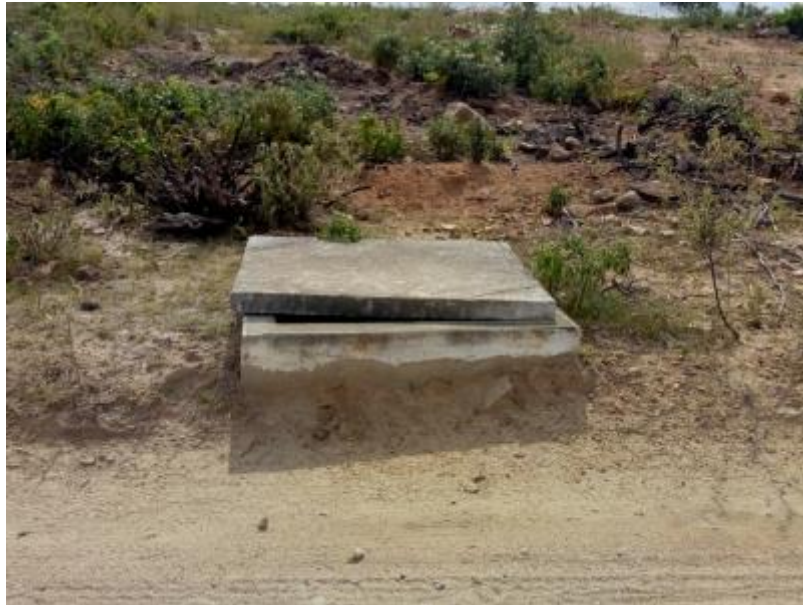
Figura 191 – Estrutura do SAA CODEVASF Inacabado Fonte: INSTITUTO GESOIS, 2021.
