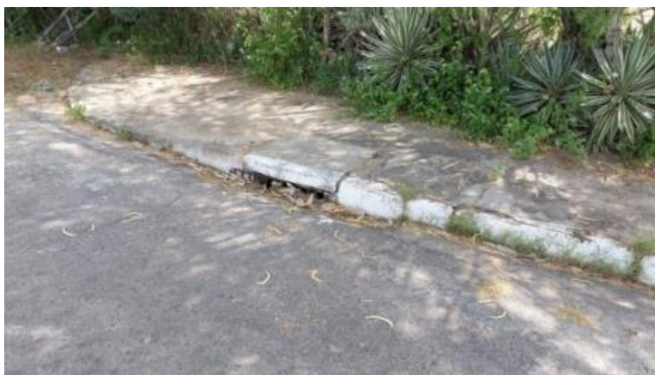
Figura 328 – Boca de Lobo com Acúmulo de Resíduos Fonte: INSTITUTO GESOIS, 2020.
