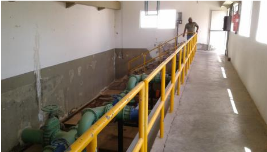
Figura 37 – ETA, Bombeamento Fonte: INSTITUTO GESOIS, 2021.
