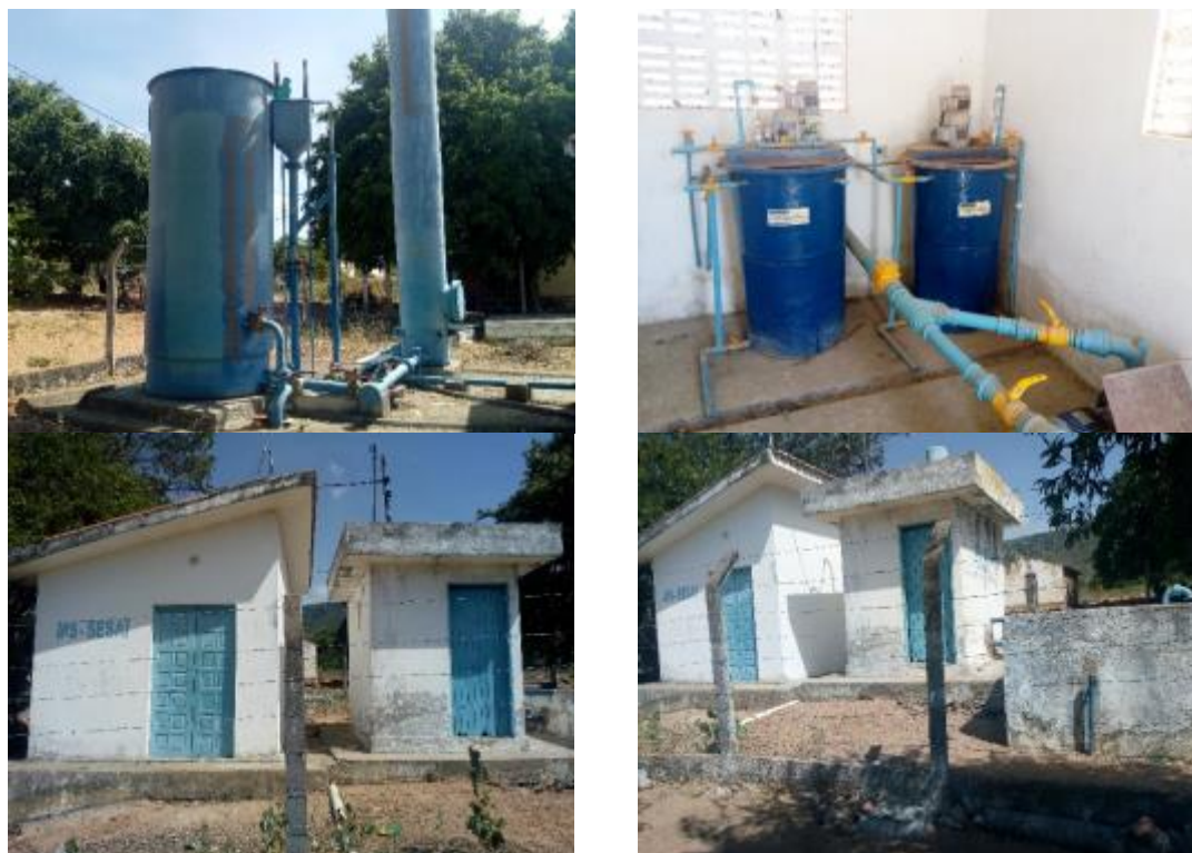
Figura 118 – ETA SESAI Desativada na Aldeia Bem Querer de Cima Fonte: INSTITUTO GESOIS, 2021.
