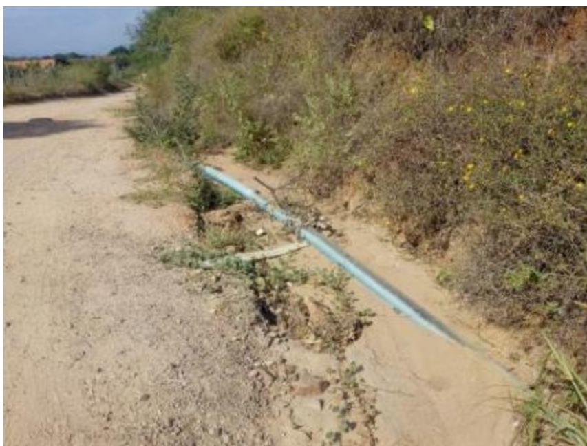
Figura 116 – Rede de Distribuição Exposta da Aldeia Bem Querere de Cima Fonte: INSTITUTO GESOIS, 2021.
