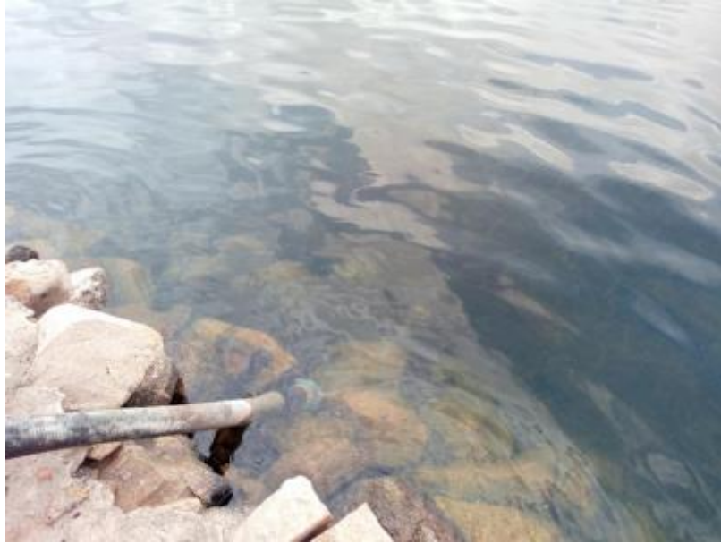
Figura 178 – Captação Fonte: INSTITUTO GESOIS, 2021.
