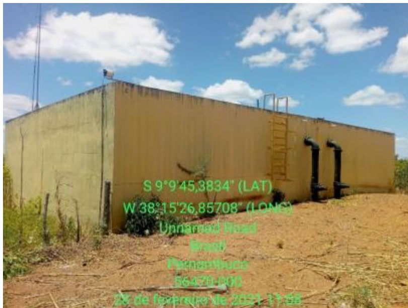
Figura 124 – Reservatório R1 do Sistema Jatobá-Caraibeiras-Tacarátú Fonte: INSTITUTO GESOIS, 2021.
