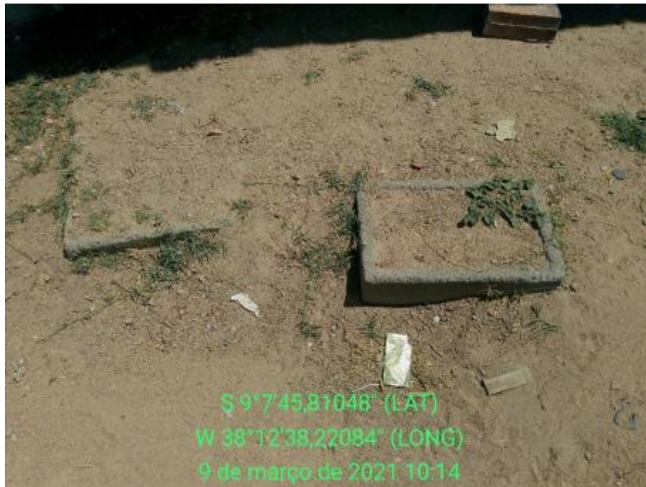
Figura 143 – Hidrômetro, na Aldeia Saco dos Barros Fonte: INSTITUTO GESOIS, 2021.
