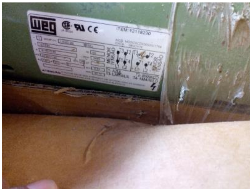
Figura 170 – Bomba D'água da Captação Fonte: INSTITUTO GESOIS, 2021.
