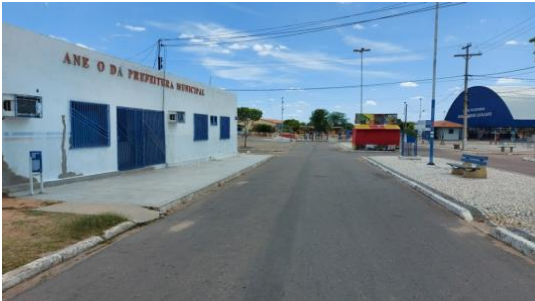
Figura 305 – Detalhe de Estruturas Inadequadas Construídas na Sarjeta Fonte: INSTITUTO GESOIS, 2020.
