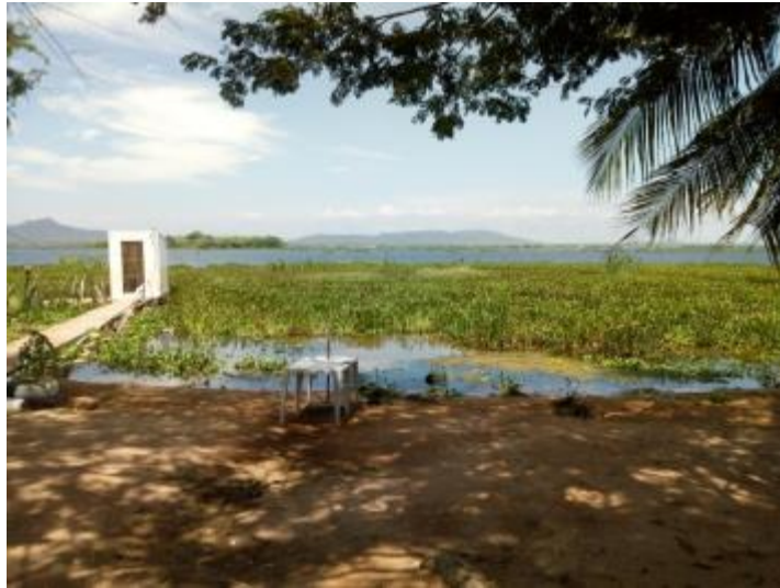
Figura 158 – Captação no Rio São Francisco Fonte: INSTITUTO GESOIS, 2021.
