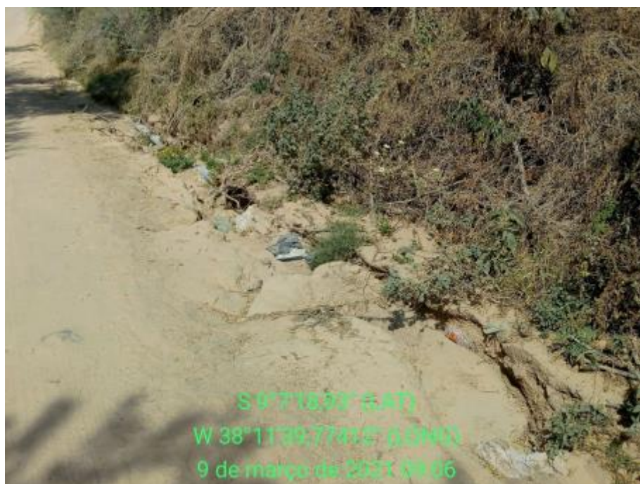
Figura 142 – Tubulação Exposta na Aldeia Saco dos Barros Fonte: INSTITUTO GESOIS, 2021.
