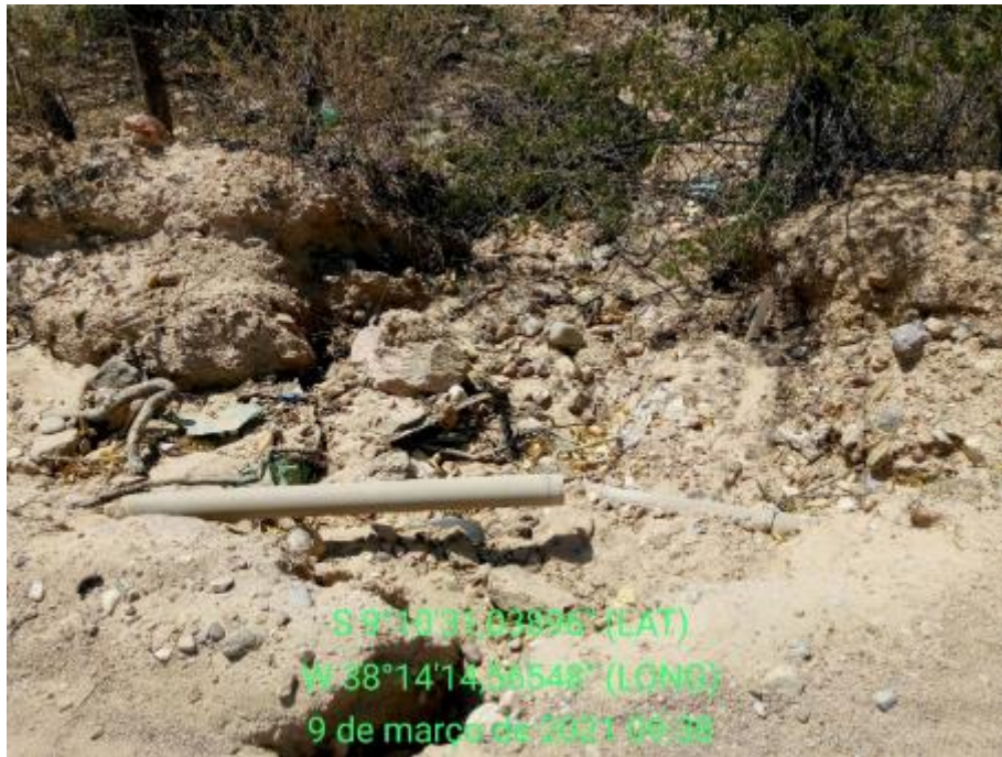
Figura 110 – Rede de Distribuição Parcialmente Destruída Fonte: INSTITUTO GESOIS, 2021
