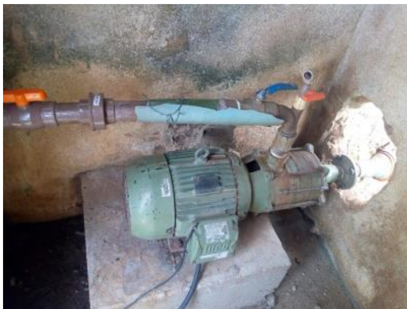
Figura 201 – Bomba da Captação Fonte: INSTITUTO GESOIS, 2021.
