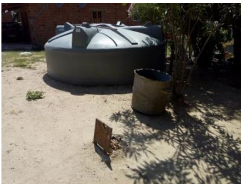
Figura 112 – Cisterna Desativada da Aldeia Bem Querer de Cima Fonte: INSTITUTO GESOIS, 2021.
