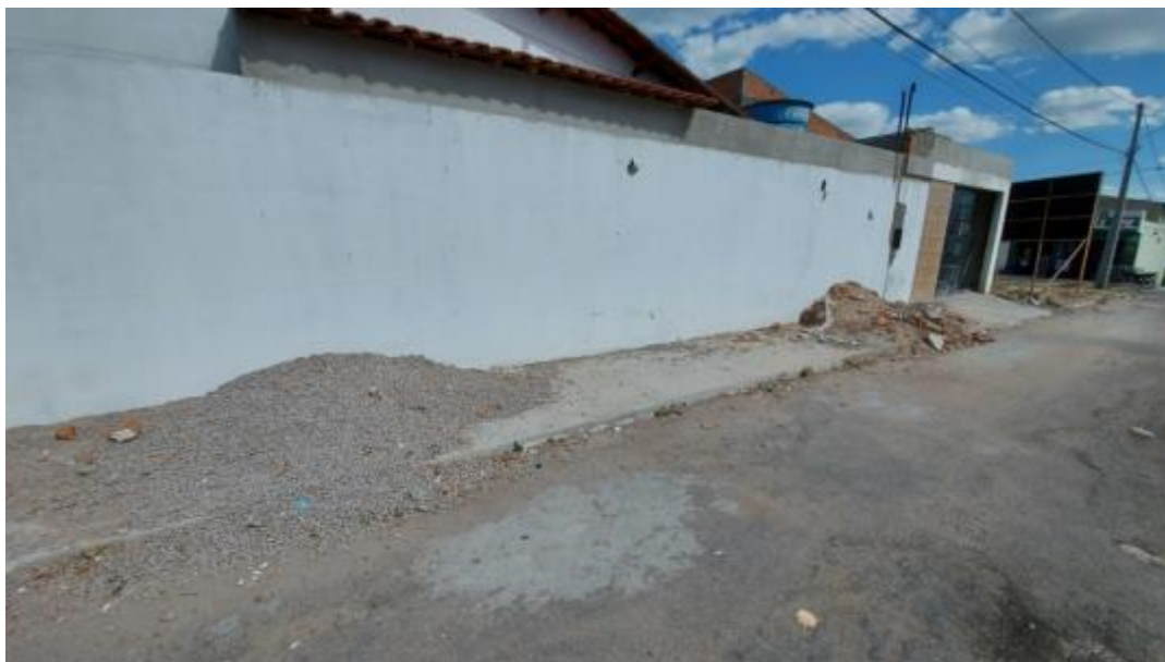
Figura 346 – Acúmulo de Entulho e Materiais na Calçada e Falta de Elementos de Drenagem
