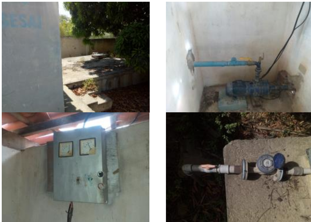
Figura 122 – Casa de Bombas da Aldeia Caxiado Fonte: INSTITUTO GESOIS, 2021.
