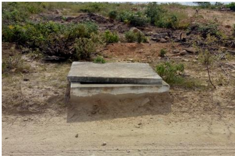
Figura 356 – Via sem Pavimentação e Sistema de Drenagem na Localidade Santa Rita
