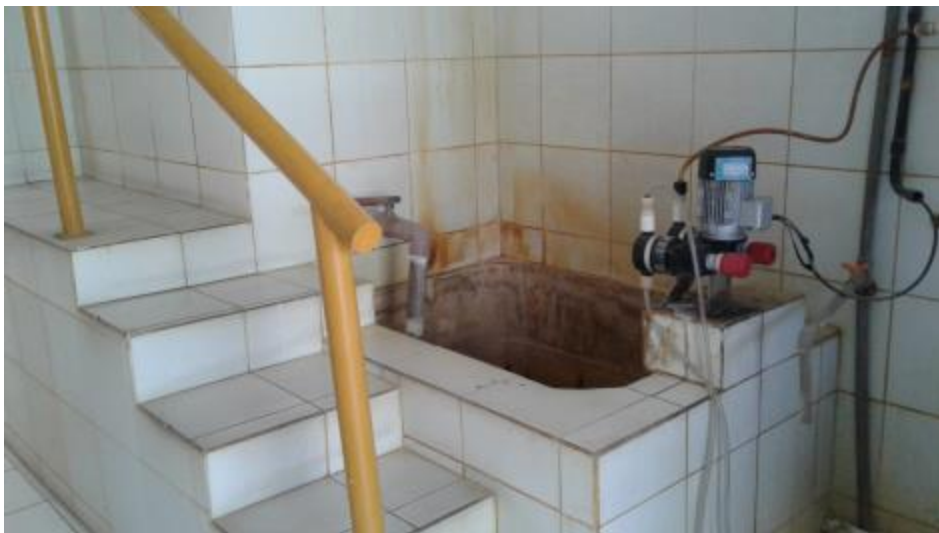
Figura 34 – ETA, Clorador Fonte: INSTITUTO GESOIS, 2021.
