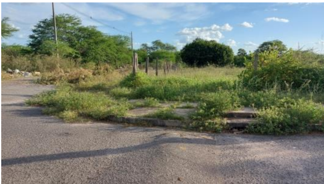
Figura 326 – Detalhe da Obstrução do Sistema de Drenagem por Vegetação Fonte: INSTITUTO GESOIS, 2020.
