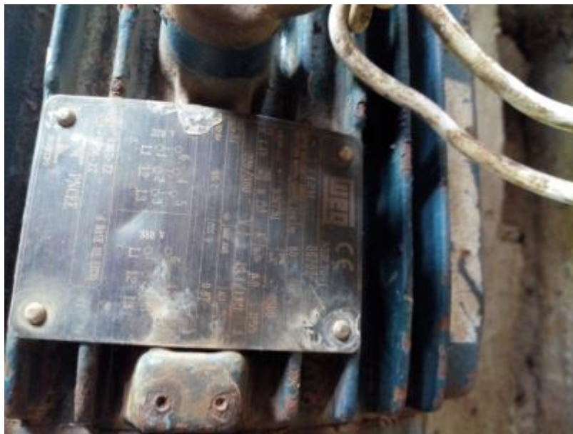
Figura 185 – Bomba da Captação Fonte: INSTITUTO GESOIS, 2021.
