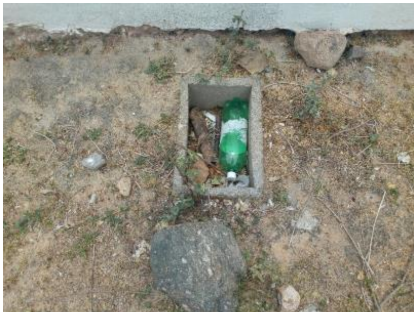
Figura 207 – Caixas para Hidrômetros, Inoperante Fonte: INSTITUTO GESOIS, 2021.
