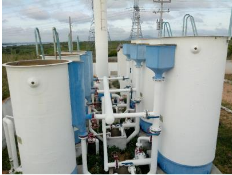
Figura 54 – ETA na Localidade Volta do Moxotó Fonte: INSTITUTO GESOIS, 2021.
