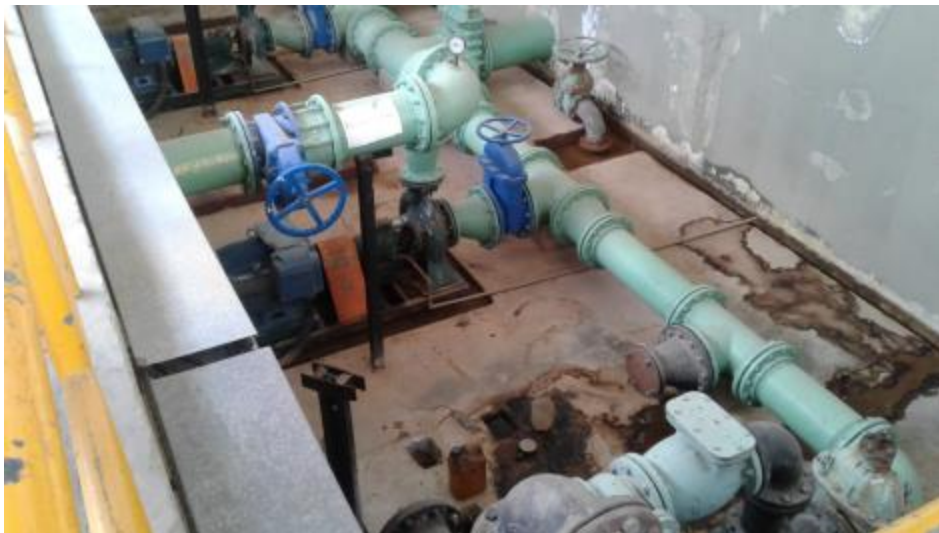
Figura 38 – ETA, Bombeamento Fonte: INSTITUTO GESOIS, 2021.
