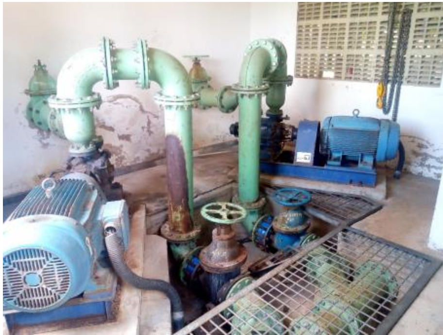
Figura 98 – Bombas da EEAT 1 Fonte: INSTITUTO GESOIS, 2021.
