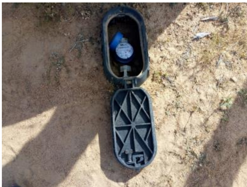
Figura 147 – Hidrômetro no Assentamento Cidadania Fonte: INSTITUTO GESOIS, 2021.
