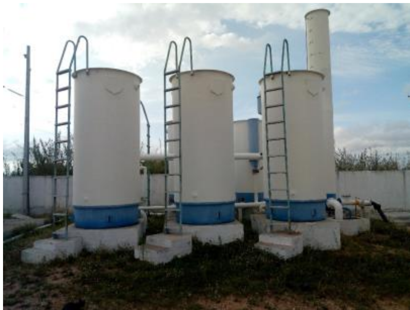
Figura 55 – ETA na Localidade Volta do Moxotó Fonte: INSTITUTO GESOIS, 2021.
