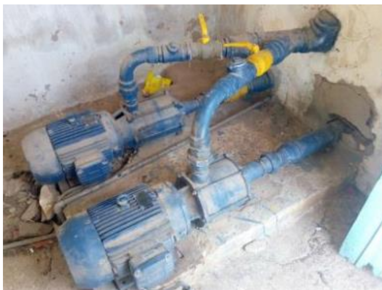
Figura 114 – Bombas da Captação SESAI Desativada Fonte: INSTITUTO GESOIS, 2021.
