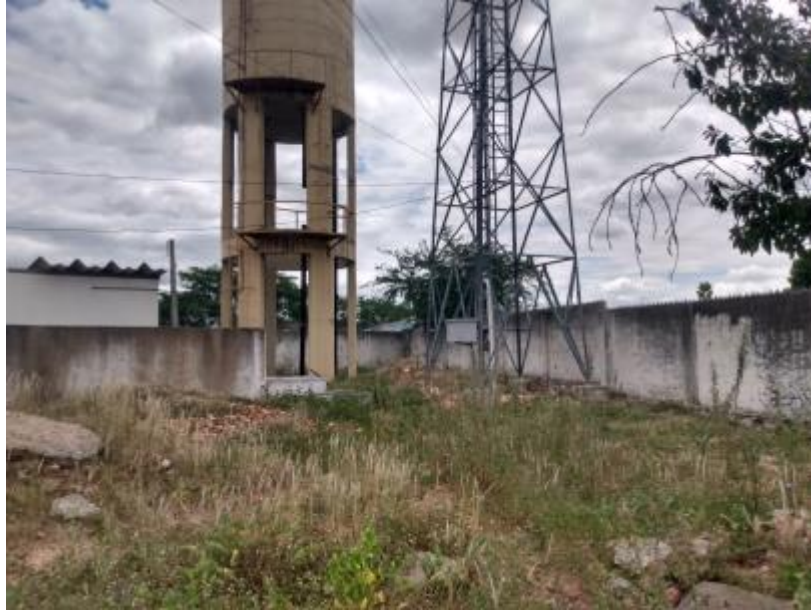
Figura 81 – Caixa D'água Inoperante da Localidade Volta do Moxotó Fonte: INSTITUTO GESOIS, 2021.
