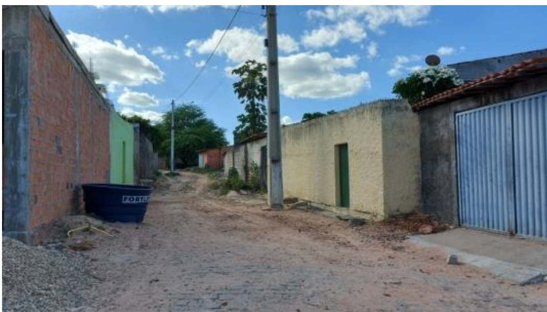
Figura 347 – Vias sem Pavimentação no Distrito de Volta do Moxotó
