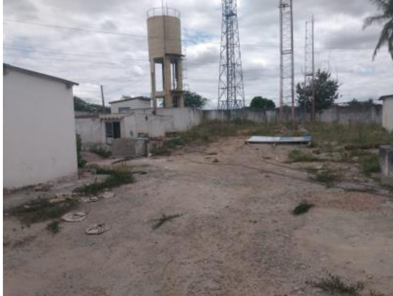
Figura 77 – Caixa D'água Inoperante da Localidade Volta do Moxotó Fonte: INSTITUTO GESOIS, 2021.
