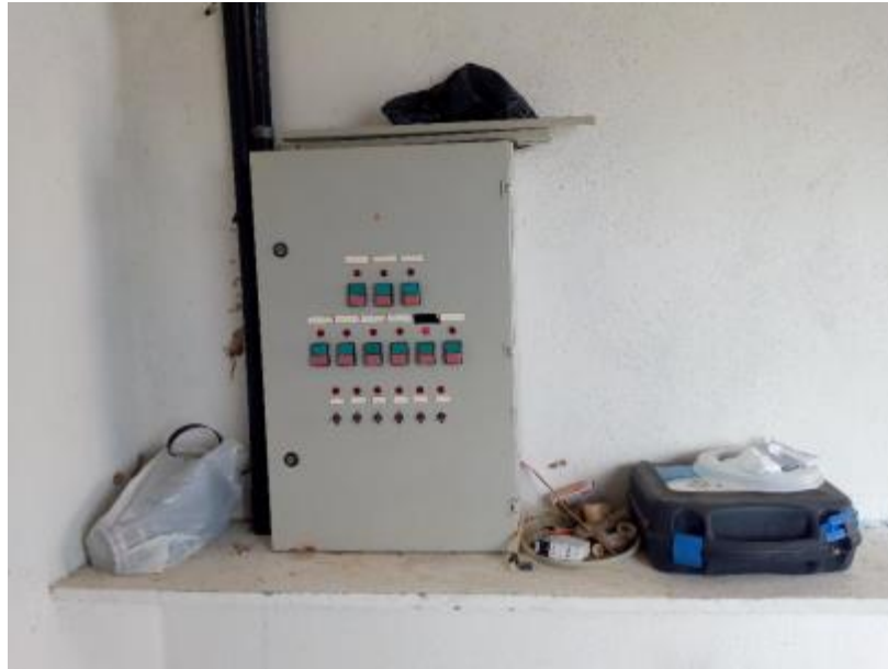
Figura 62 – ETA na Localidade Volta do Moxotó Fonte: INSTITUTO GESOIS, 2021.
