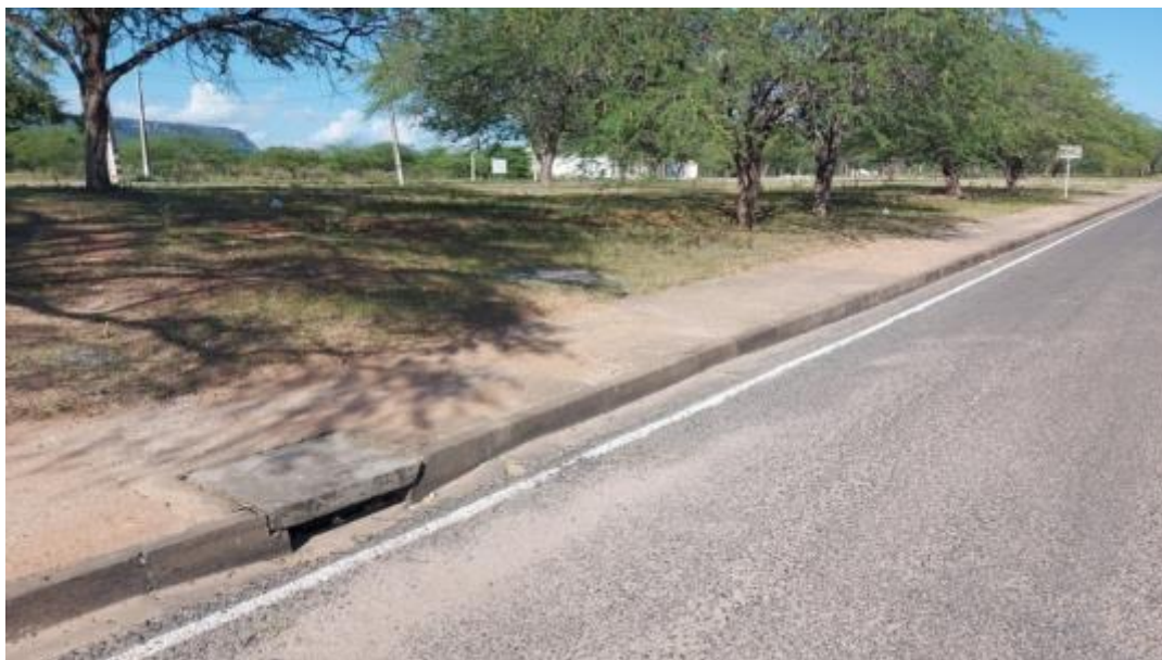
Figura 321 – Detalhe da Boca de Lobo Localizada na Av. Eletrobrás Sul Fonte: INSTITUTO GESOIS, 2020.
