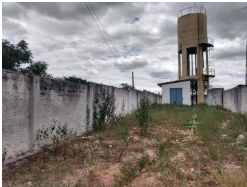
Figura 72 – Reservatório Inoperante da Volta do Moxotó Fonte: INSTITUTO GESOIS, 2021.
