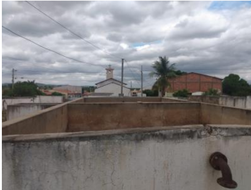
Figura 73 – Reservatório Inoperante da Volta do Moxotó Fonte: INSTITUTO GESOIS, 2021.
