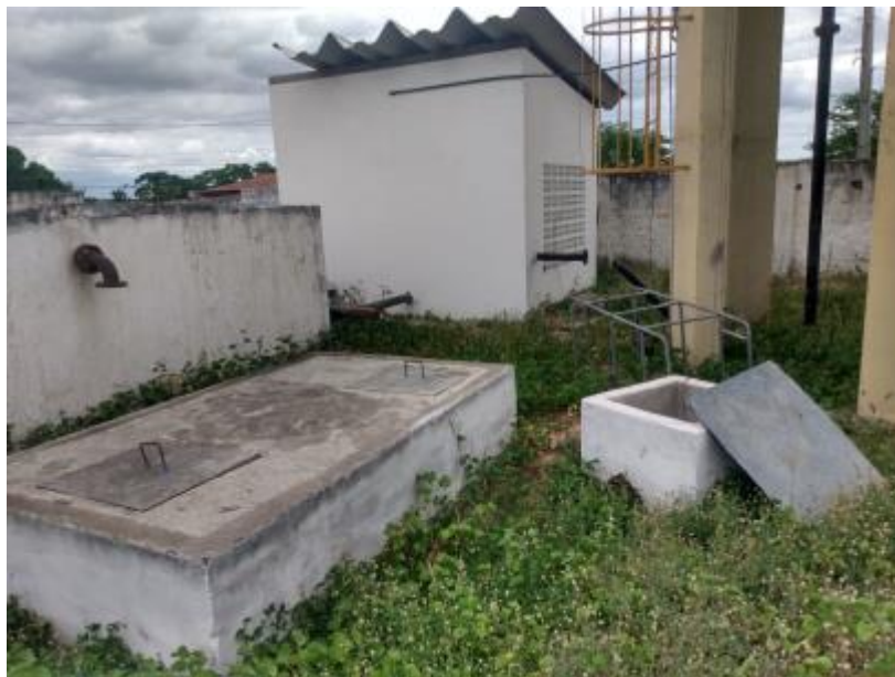
Figura 78 – Caixa D'água Inoperante da Localidade Volta do Moxotó Fonte: INSTITUTO GESOIS, 2021.
