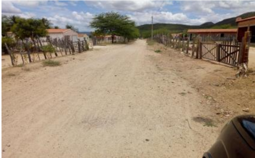
Figura 360 – Via Principal sem Pavimentação e Drenagem na Localidade Camaratu Fonte: INSTITUTO GESOIS, 2020.
