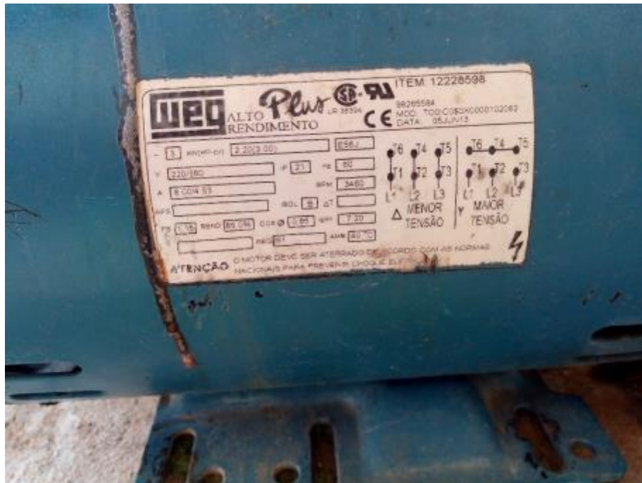
Figura 160 – Bomba da Captação Fonte: INSTITUTO GESOIS, 2021.
