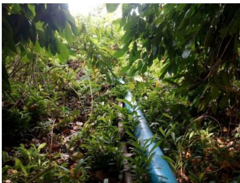
Figura 168 – Adutora Fonte: INSTITUTO GESOIS, 2021.
