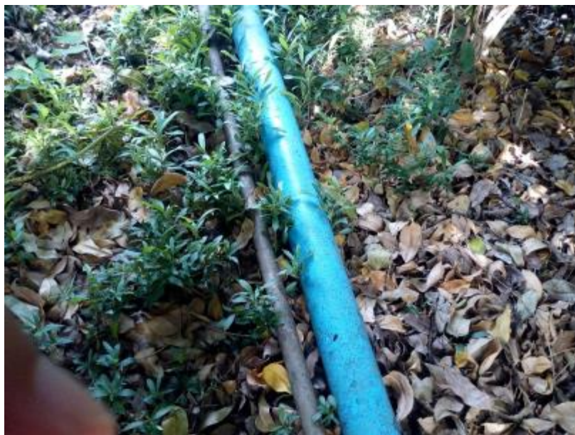
Figura 167 – Adutora Fonte: INSTITUTO GESOIS, 2021.
