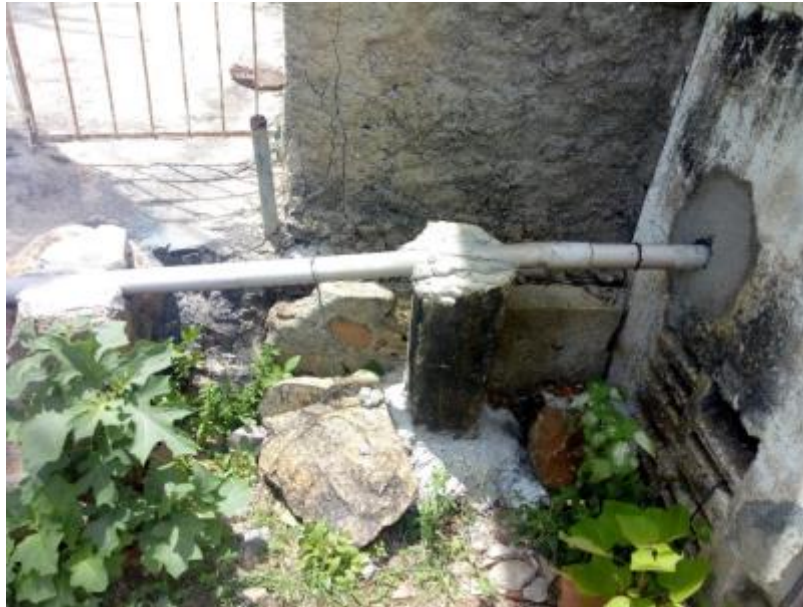
Figura 200 – Captação Fonte: INSTITUTO GESOIS, 2021.
