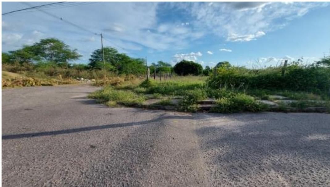
Figura 325 – Obstrução do Sistema de Drenagem por Vegetação Fonte: INSTITUTO GESOIS, 2020.
