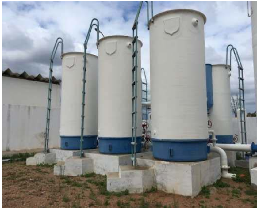
Figura 51 – ETA , COMPESA, Distrito Volta do Moxotó Fonte: COMPESA, 2021.
