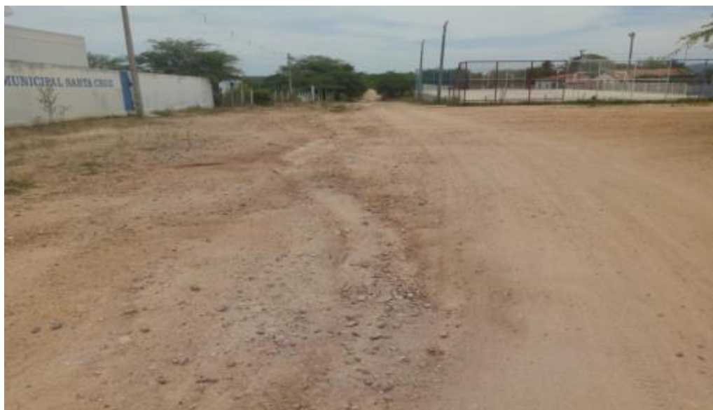
Figura 350 – Vista da via com Escola e Quadra Poliesportiva Apresentando Marcas de escoamento superficial no solo na Localidade Umbranas Fonte: INSTITUTO GESOIS, 2020.
