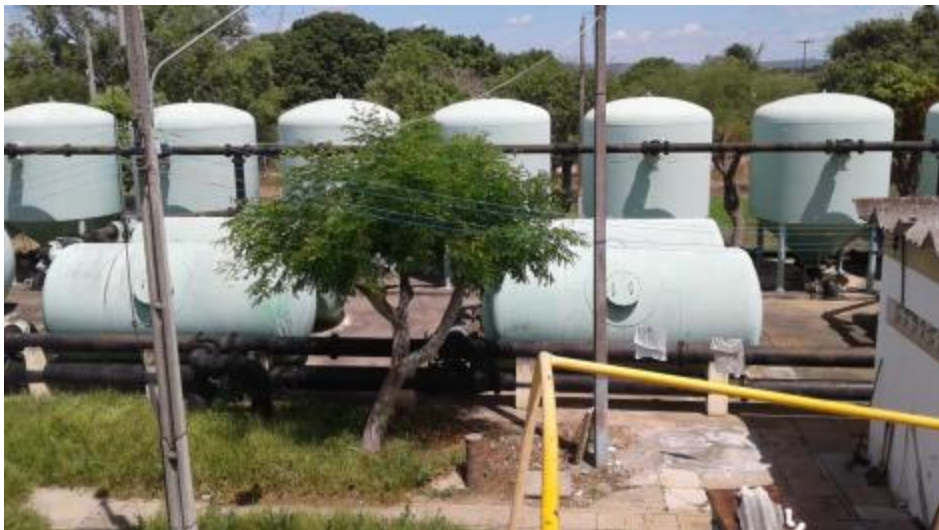
Figura 36 – ETA, Filtros Fonte: INSTITUTO GESOIS, 2021.
