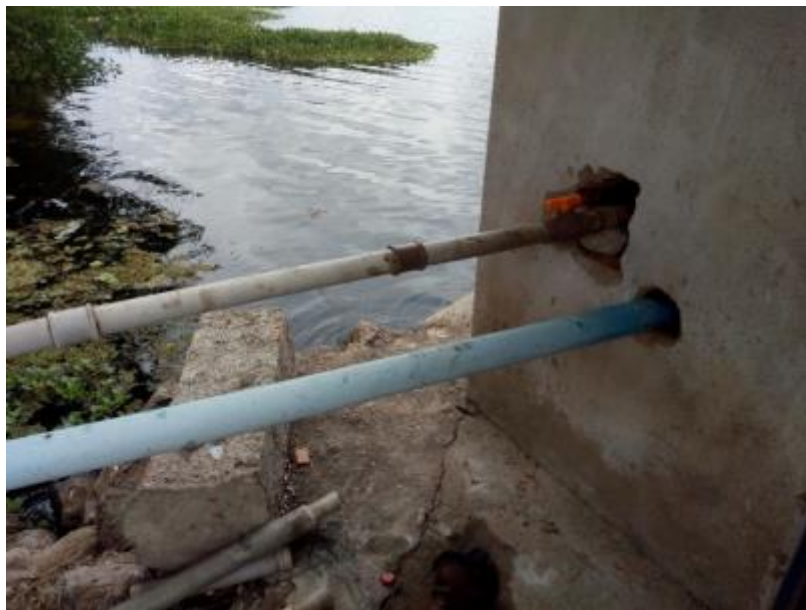
Figura 179 – Captação Fonte: INSTITUTO GESOIS, 2021.
