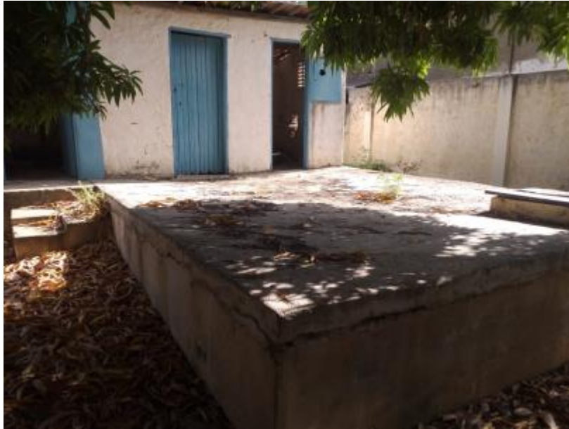
Figura 123 – Cisterna da Casa de Bombas da Aldeia Caxiado Fonte: INSTITUTO GESOIS, 2021.
