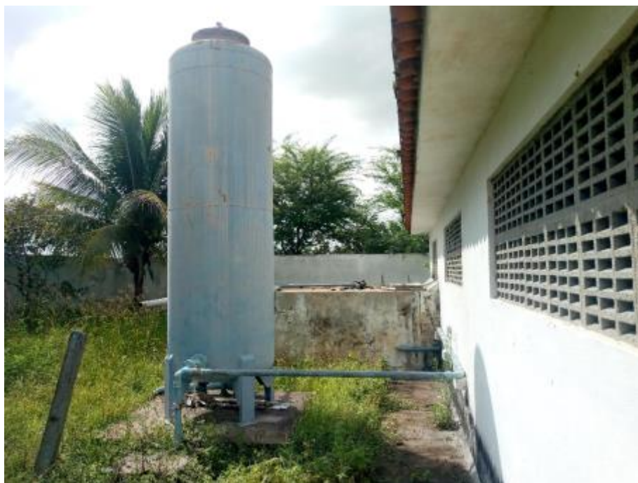
Figura 128 – ETA Desativada na Aldeia Caldeirão Fonte: INSTITUTO GESOIS, 2021.
