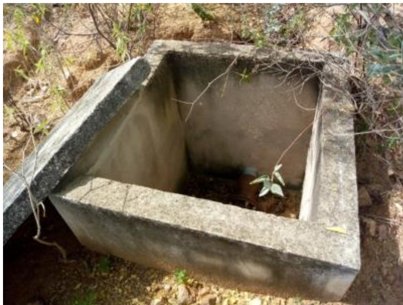
Figura 190 – Estrutura do SAA CODEVASF Inacabado Fonte: INSTITUTO GESOIS, 2021.
