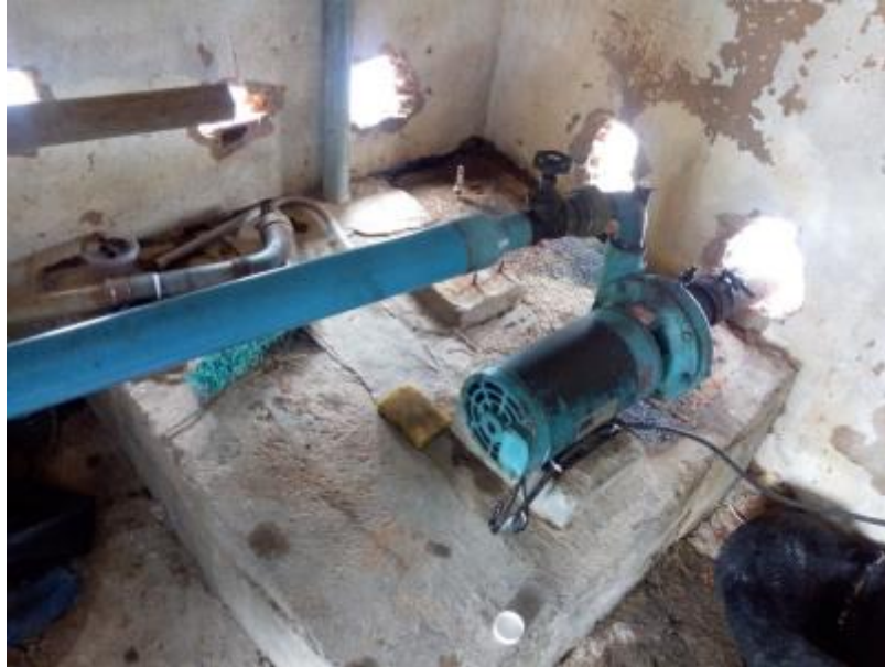
Figura 180 – Bombas da Captação Fonte: INSTITUTO GESOIS, 2021.
