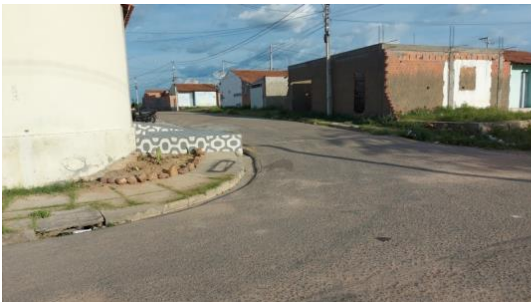
Figura 333 – Boca de Lobo Depreciada na Rua Boa Esperança (Bairro Itaparica) Fonte: INSTITUTO GESOIS, 2020.
