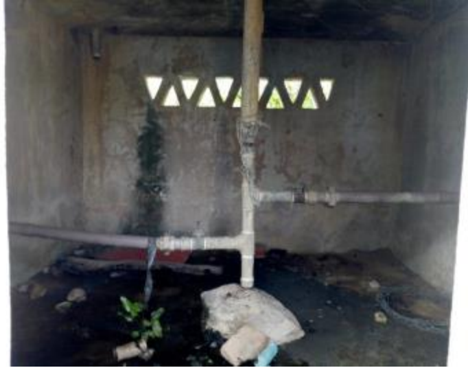
Figura 188 – RAP Desativado Fonte: INSTITUTO GESOIS, 2021.
