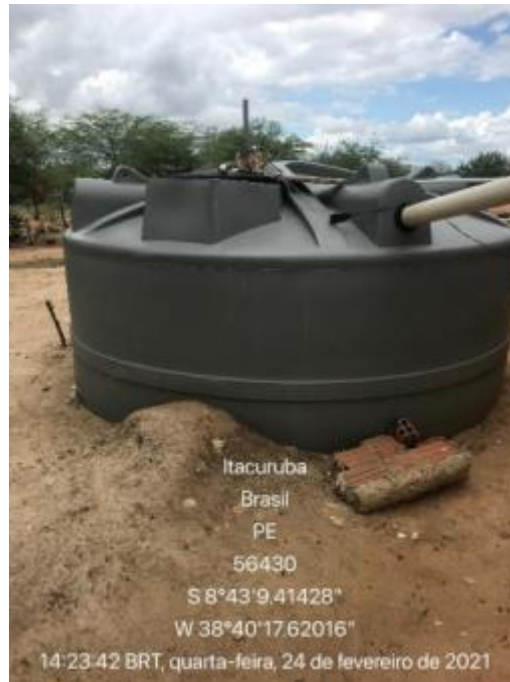
Figura 63 – Cisterna de uso coletivo, em PVC Fonte: INSTITUTO GESOIS, 2021.
