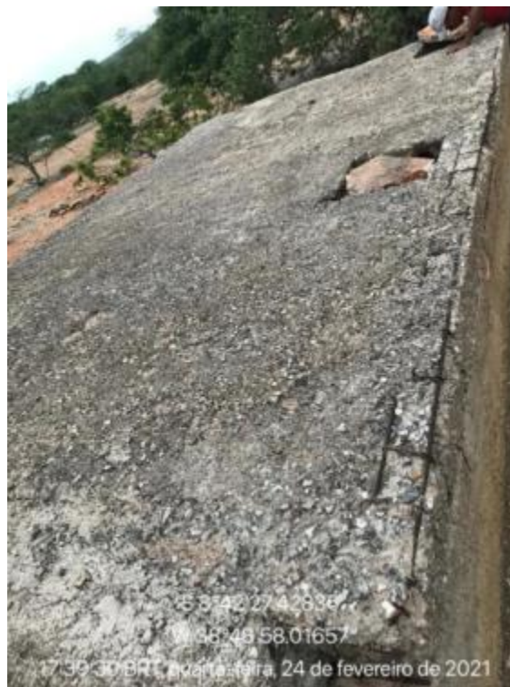
Figura 107 – Fossa séptica da Comunidade Maria Preta. Fonte: INSTITUTO GESOIS, 2021.
