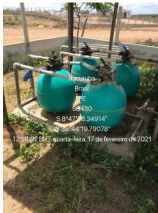
Figura 86 – Sistema de filtros, desativado Fonte: INSTITUTO GESOIS, 2021.
