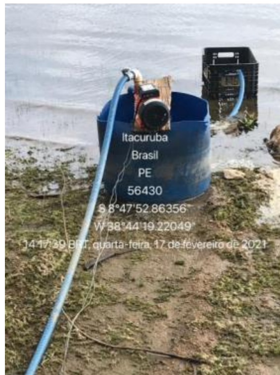
Figura 46 – Captação de Água Comunidade Tuxá Campos Fonte: INSTITUTO GESOIS, 2021.
