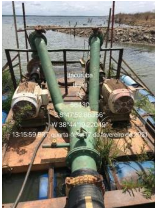
Figura 83 – Captação de água bruta Fonte: INSTITUTO GESOIS, 2021.
