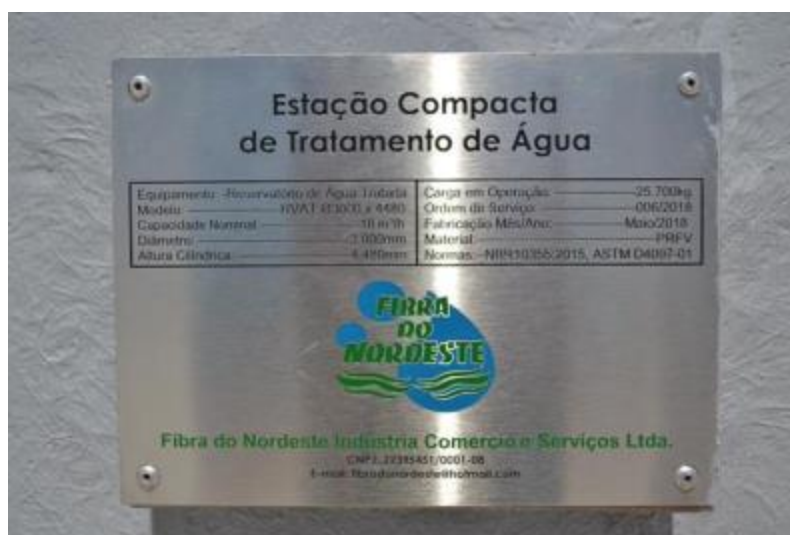
Figura 51 – Placa de identificação da ETA
