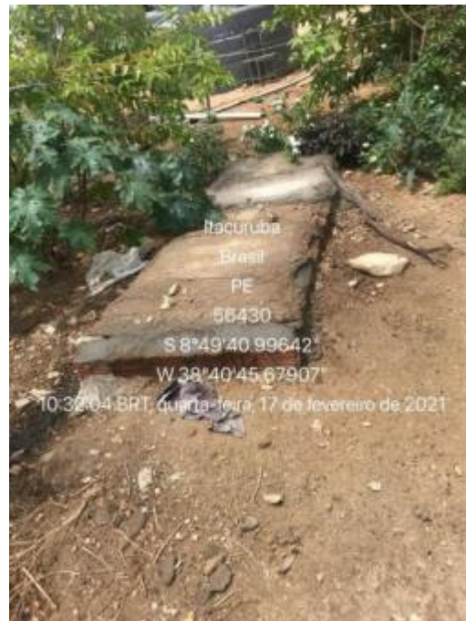
Figura 104 – Fossa séptica da Comunidade Lealdade 2. Fonte: INSTITUTO GESOIS, 2021.
