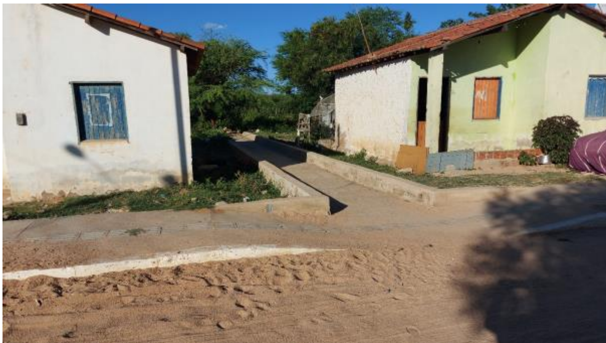
Figura 166 – Acúmulo de areia na rampa de acessibilidade Fonte: INSTITUTO GESOIS, 2020.
