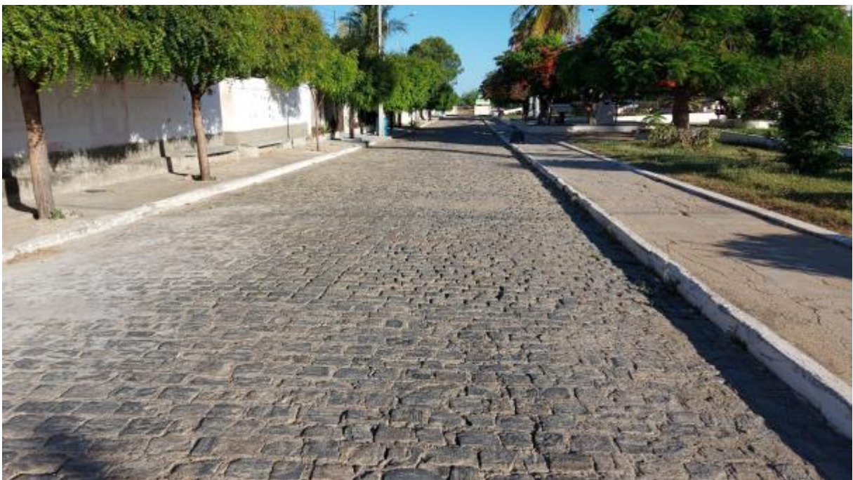
Figura 163 – Aspecto da via sem dispositivos de drenagem Fonte: INSTITUTO GESOIS, 2020.
