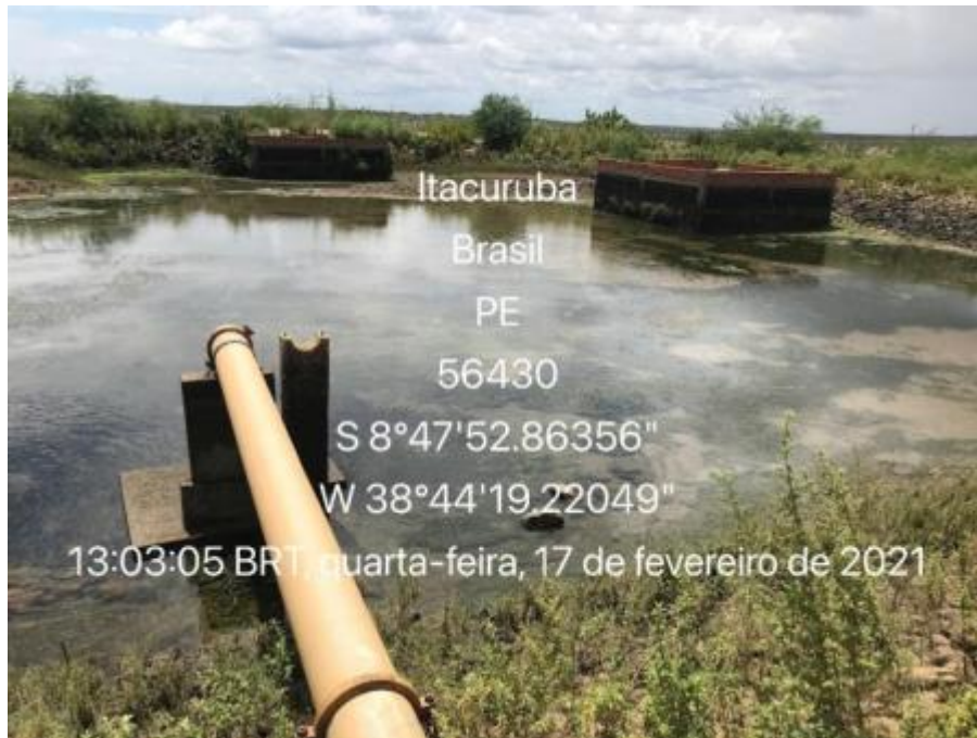
Figura 85 – Estação elevatória de água bruta, com filtros de pedra Fonte: INSTITUTO GESOIS, 2021.
