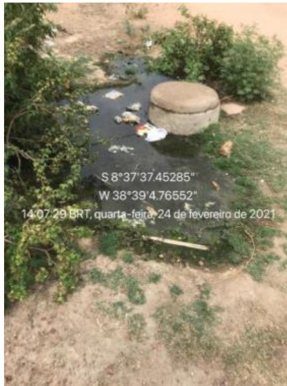
Figura 102 – Fossa negra da Comunidade Angico II. Fonte: INSTITUTO GESOIS, 2021.
