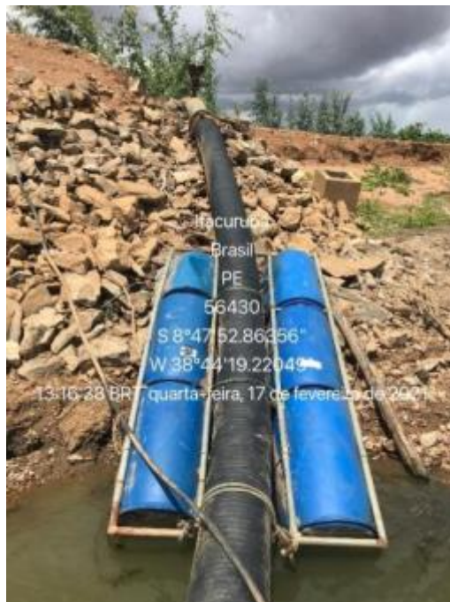
Figura 84 – Adutora de água bruta Fonte: INSTITUTO GESOIS, 2021.
