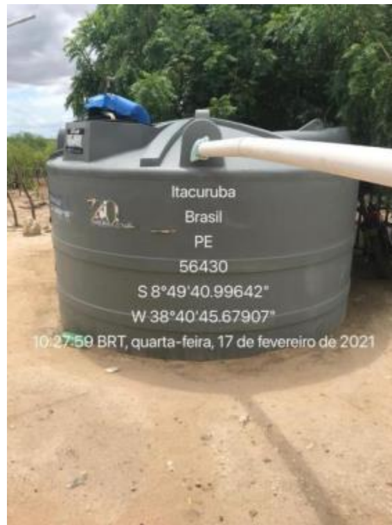
Figura 69 – Caixa D'água Coletiva na Comunidade Lealdade 2. Fonte: INSTITUTO GESOIS, 2021.
