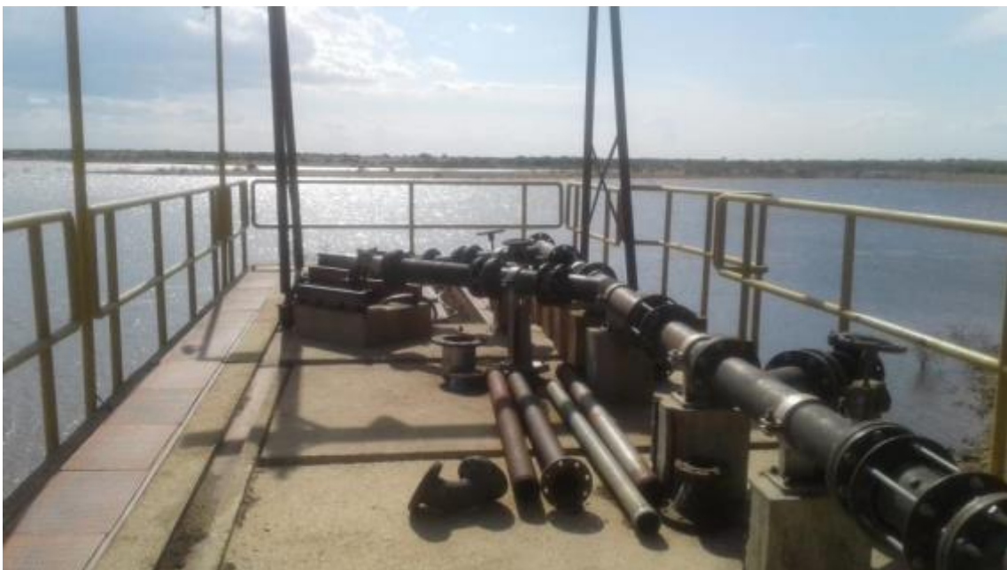
Figura 26 – Captação no Rio São Francisco. Fonte: INSTITUTO GESOIS, 2021.
