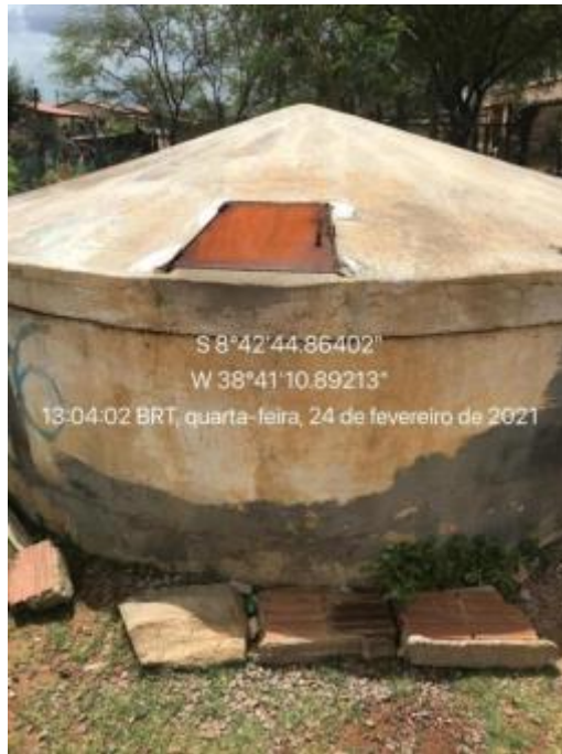
Figura 60 – Cisterna de uso coletivo Fonte: INSTITUTO GESOIS, 2021.
