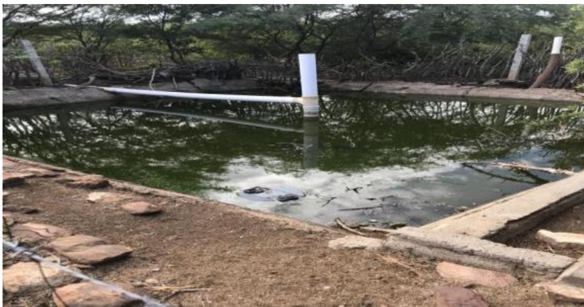
Figura 103 - Lagoa de estabilização da Comunidade Angico III. Fonte: INSTITUTO GESOIS, 2021.
