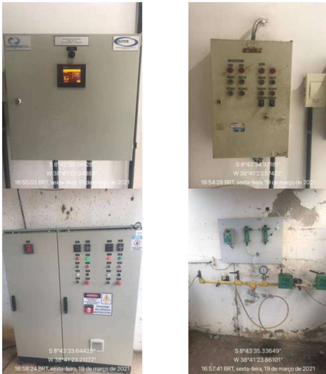
Figura 33 – Quadros de comando e clorador Fonte: INSTITUTO GESOIS, 2021.
