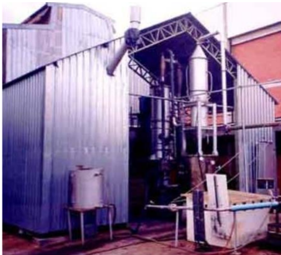
Figura 128– Planta de Pirólise com Tecnologia da Unicamp Fonte: AMBIENTE BRASIL, 2017.
