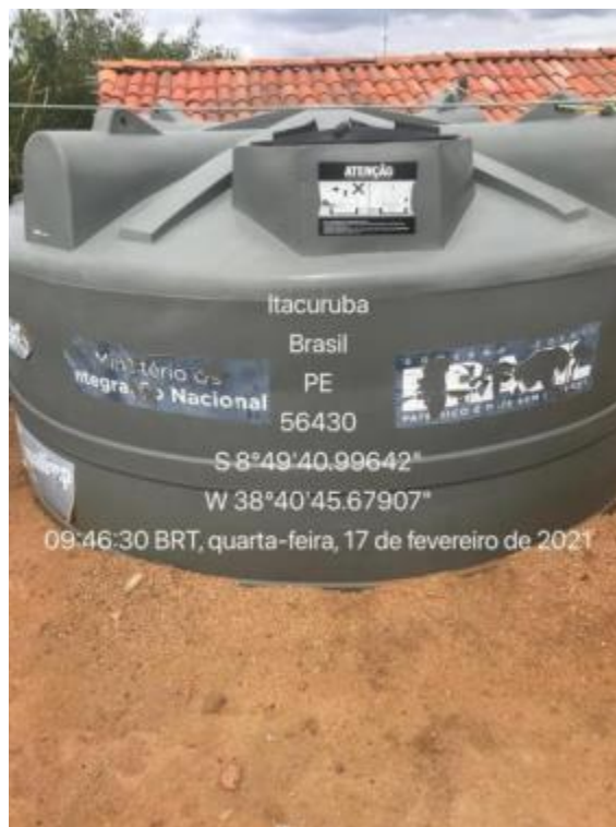
Figura 78 – Cisterna, em PVC
