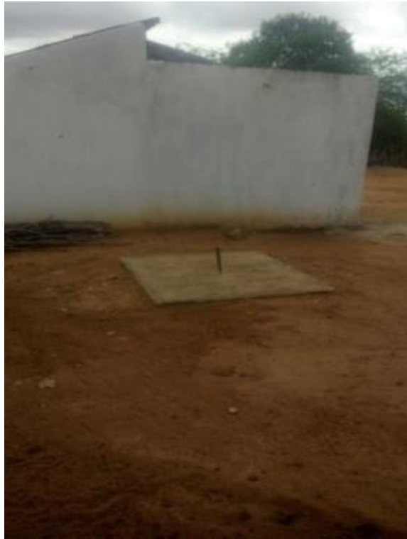
Figura 96 – Fossa negra Fonte: INSTITUTO GESOIS, 2021.
