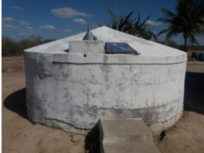
Figura 211 – Cisterna Fonte: INSTITUTO GESOIS, 2021
