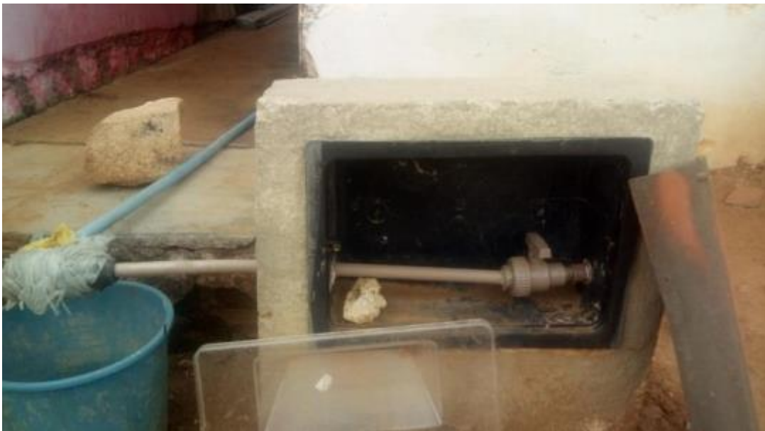
Figura 95 – Hidrômetro na rede Fonte: INSTITUTO GESOIS, 2021.
