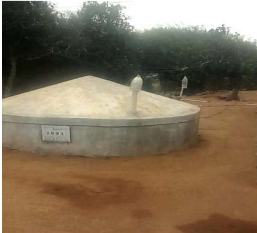
Figura 212 – Cisterna Fonte: INSTITUTO GESOIS, 2021
