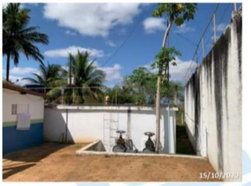
Figura 45 – Reservatório 2 EEAT-04 Fonte: ARSAL, 2020.
