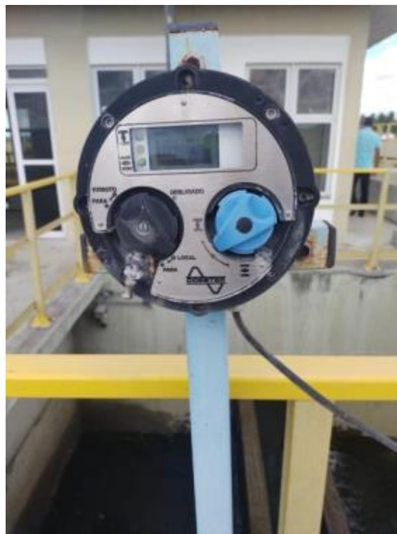
Figura 33 – Injeção de cloro Fonte: INSTITUTO GESOIS, 2021.
