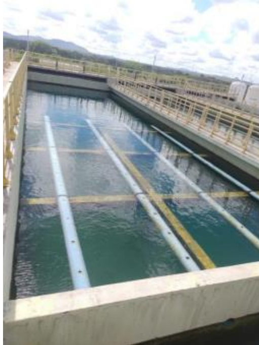
Figura 30 – Decantadores Fonte: INSTITUTO GESOIS, 2021.
