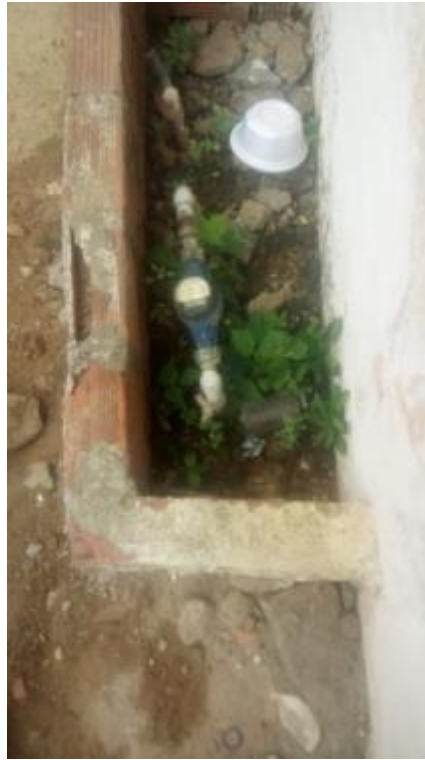
Figura 100 – Hidrômetro na rede Fonte: INSTITUTO GESOIS, 2021.
