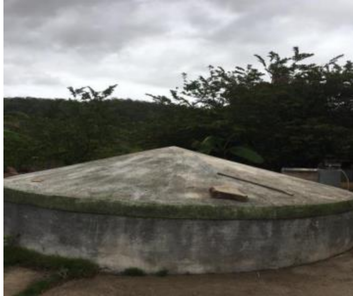
Figura 127 – Cisterna Fonte: INSTITUTO GESOIS, 2021.
