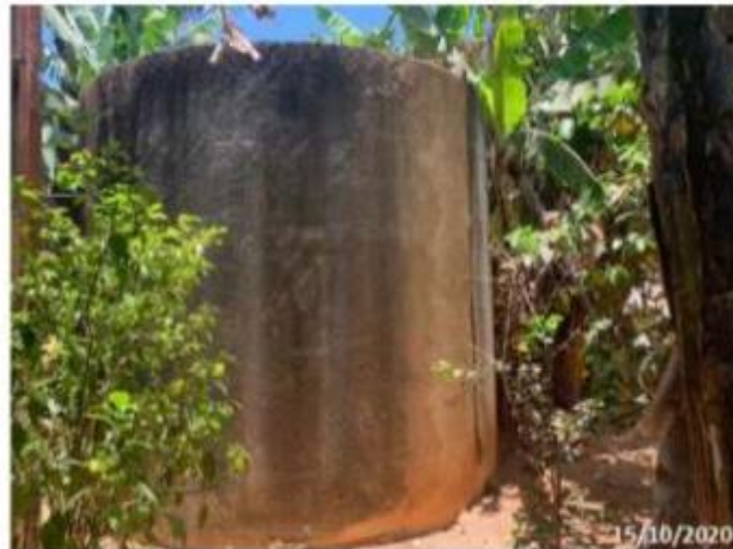
Figura 59 – Reservatório EEAT Tatajuba Fonte: ARSAL, 2020.
