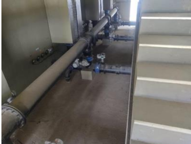
Figura 32 – Tubulação de Recalque Fonte: INSTITUTO GESOIS, 2021.
