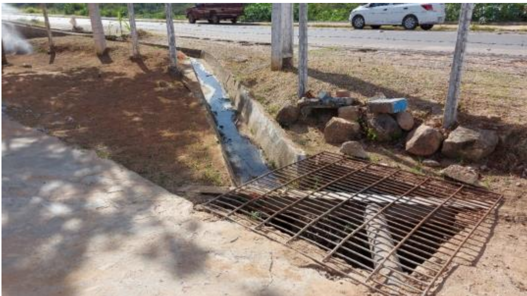
Figura 299 – Água drenada pela sarjeta diretamente para caixa coletora Fonte: INSTITUTO GESOIS, 2020.
