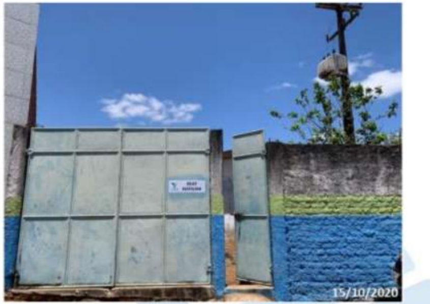
Figura 52 – Estação Elevatória Auxiliar Fonte: ARSAL, 2020.
