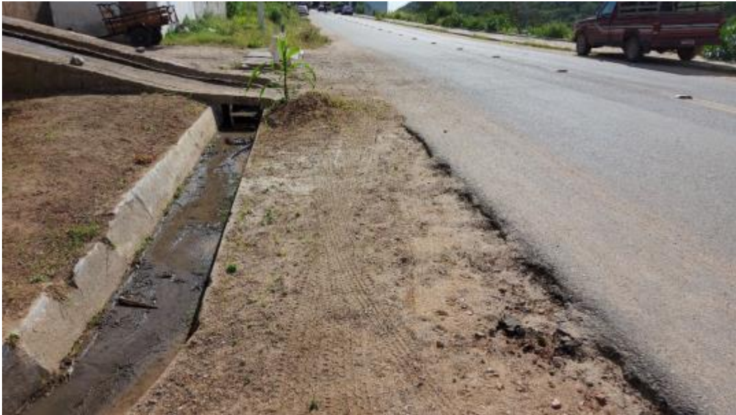
Figura 300 – Rua pavimentada com asfalto sarjeta drenando a água Fonte: INSTITUTO GESOIS, 2020.
