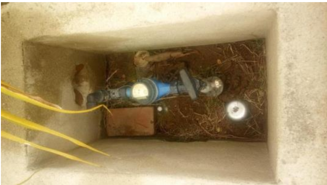
Figura 79 – Hidrômetro na rede geral Fonte: INSTITUTO GESOIS, 2021.
