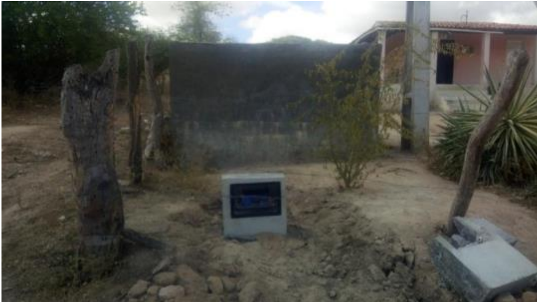
Figura 197 – Hidrômetro Fonte: INSTITUTO GESOIS, 2021.
