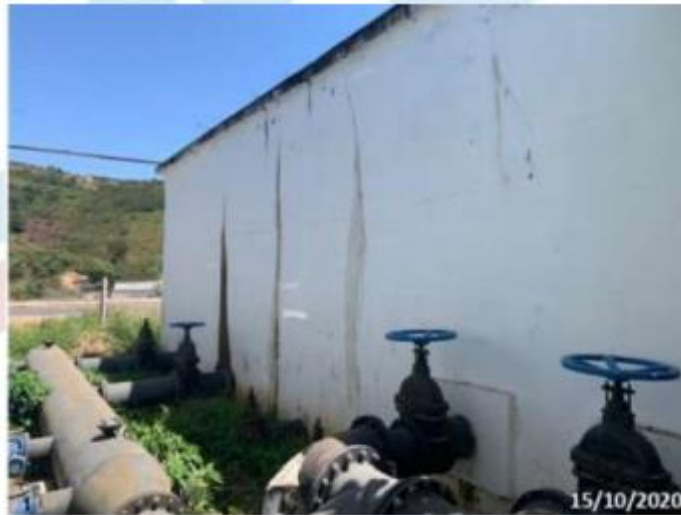
Figura 50 – Reservatório R1, EEAT- 05 Fonte: ARSAL, 2020.
