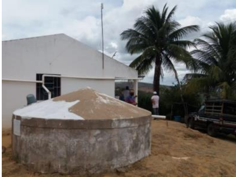
Figura 241 – Cisterna Fonte: INSTITUTO GESOIS, 2021
