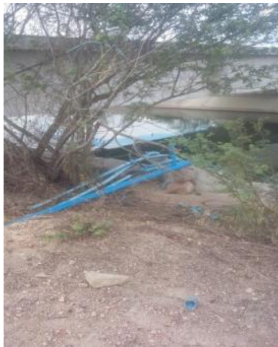
Figura 224 – Captação no Canal Fonte: INSTITUTO GESOIS, 2021.
