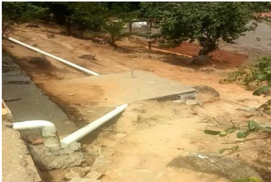
Figura 112 – Fossa Negra Fonte: INSTITUTO GESOIS, 2021.
