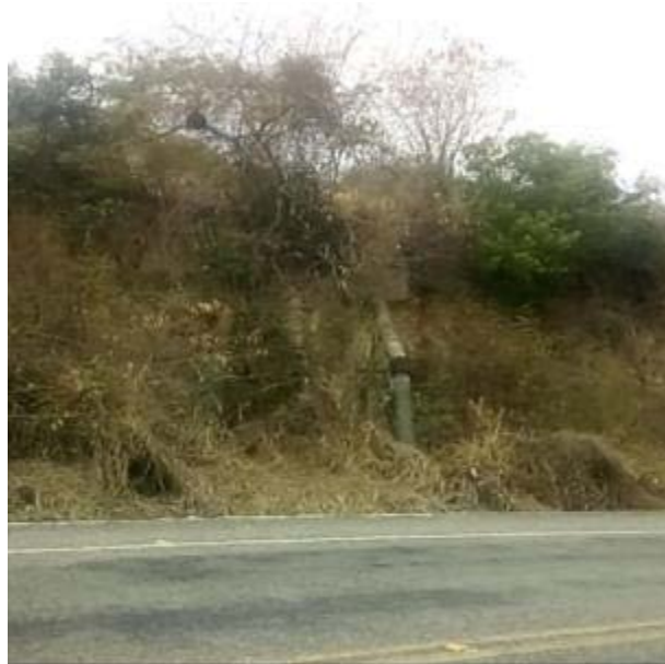
Figura 92 – Adutora Fonte: INSTITUTO GESOIS, 2021.
