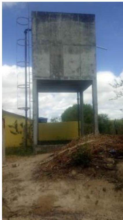
Figura 91 – Reservatório Fonte: INSTITUTO GESOIS, 2021.
