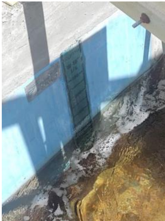
Figura 29 – Calha Parshall Fonte: INSTITUTO GESOIS, 2021.
