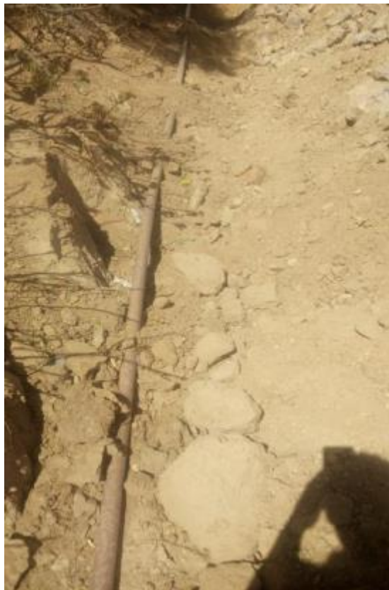
Figura 198 – Tubulação de água Fonte: INSTITUTO GESOIS, 2021.
