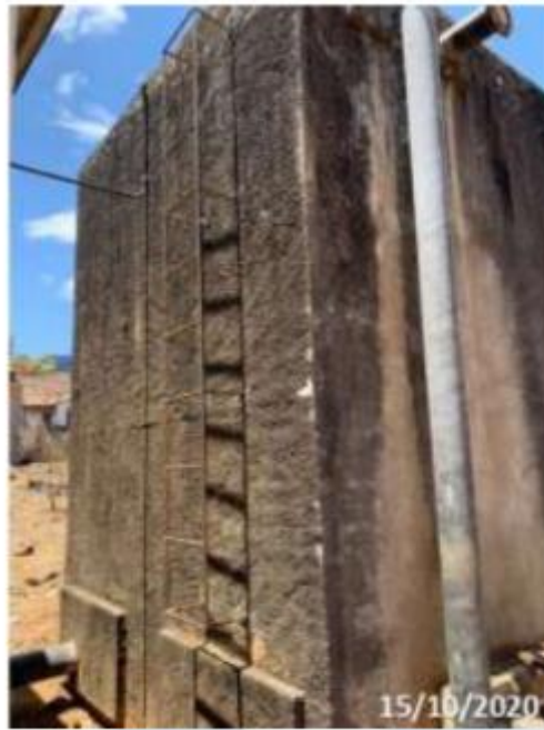
Figura 53 – Reservatório R1, EEAT Auxiliar Fonte: ARSAL, 2020.
