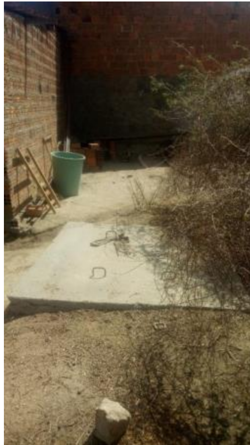
Figura 199 – Fossa Negra Fonte: INSTITUTO GESOIS, 2021
