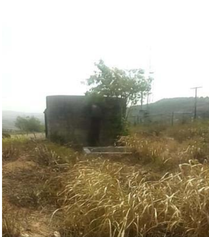
Figura 102 – Estação de Bombeamento Fonte: INSTITUTO GESOIS, 2021.
