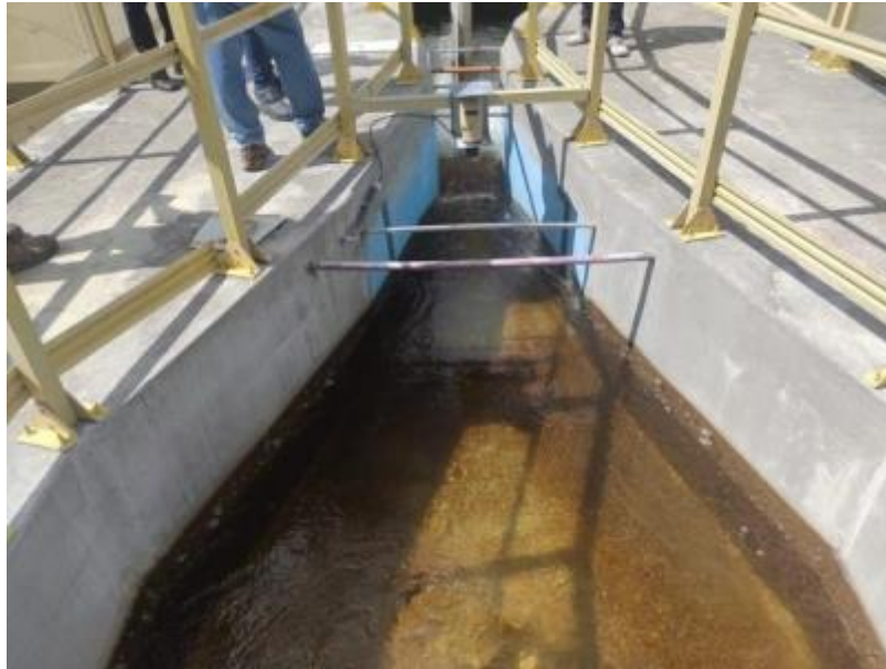
Figura 28 – Calha Parshall Fonte: INSTITUTO GESOIS, 2021.
