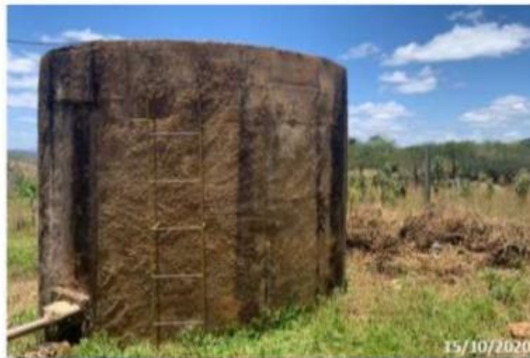
Figura 57 – Reservatório da Estação Elevatória de Ouricuri Fonte: ARSAL, 2020.
