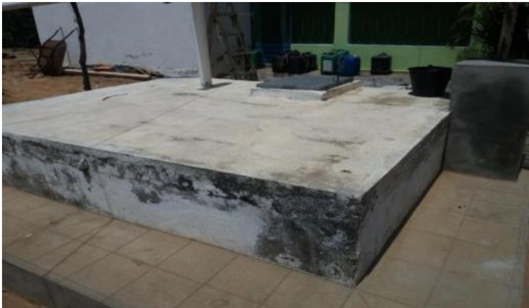
Figura 181 – Cisterna Fonte: INSTITUTO GESOIS, 2021.
