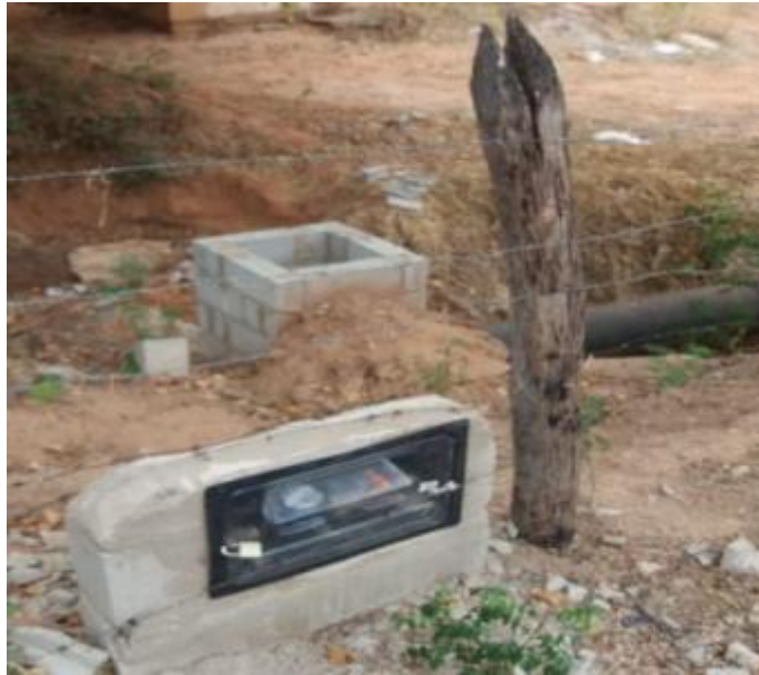
Figura 75 – Hidrômetro na Rede Fonte: INSTITUTO GESOIS, 2021.
