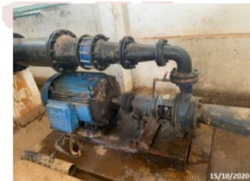
Figura 43 – Bomba EEAT-04 Fonte: ARSAL, 2020.
