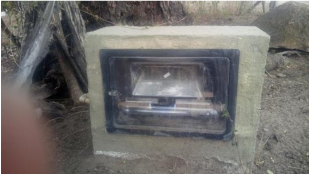
Figura 85 – Hidrômetro na rede Fonte: INSTITUTO GESOIS, 2021.
