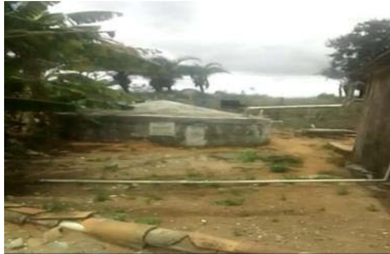
Figura 131 – Cisterna Fonte: INSTITUTO GESOIS, 2021.
