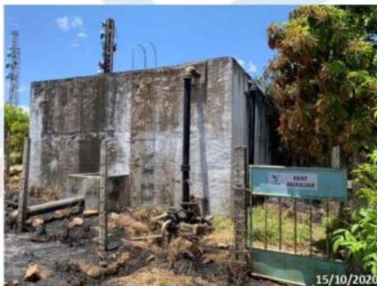
Figura 55 – Reservatório de Distribuição Fonte: ARSAL, 2020.
