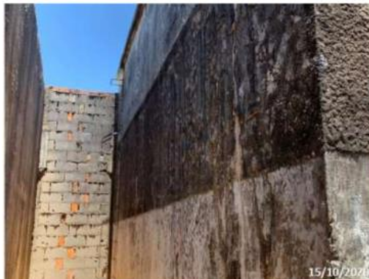
Figura 54 – Reservatório R2, EEAT Auxiliar Fonte: ARSAL, 2020.
