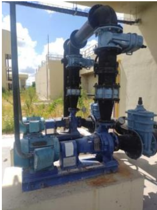
Figura 31 – Conjunto Moto-Bombas Fonte: INSTITUTO GESOIS, 2021.
