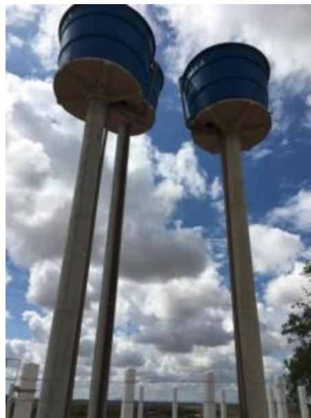
Figura 157 – Reservatórios Fonte: INSTITUTO GESOIS, 2021.
