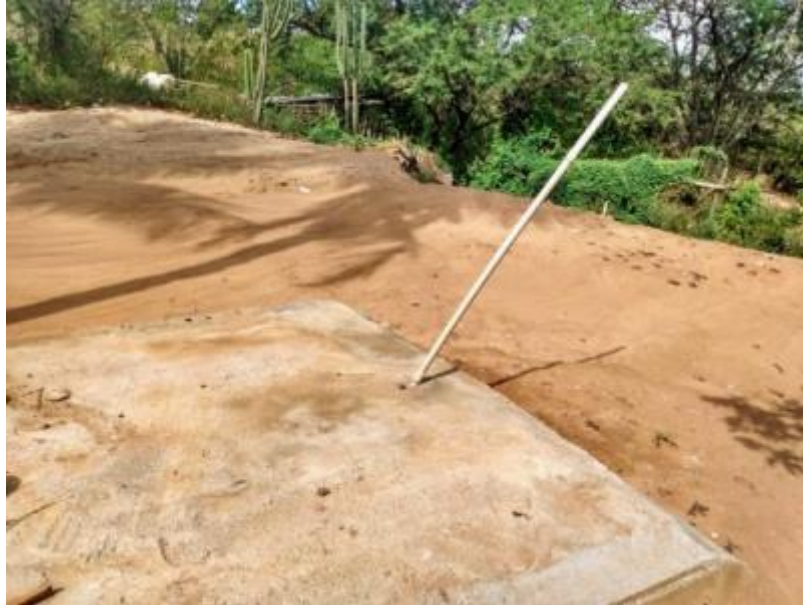
Figura 117 – Fossa negra Fonte: INSTITUTO GESOIS, 2021.
