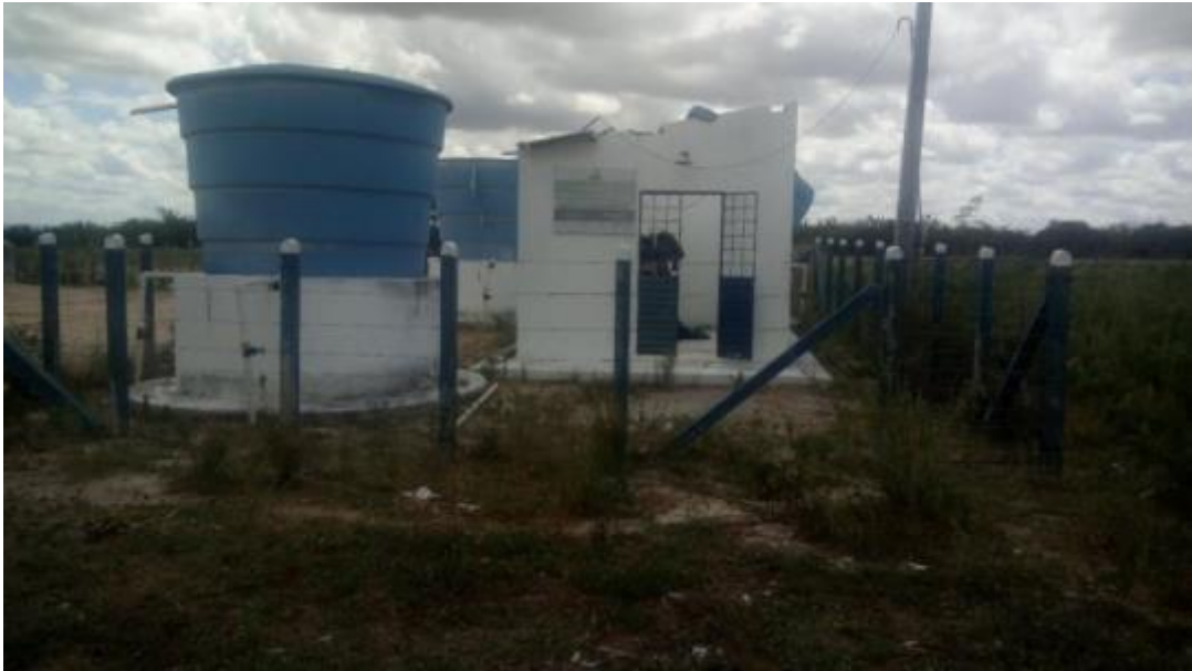
Figura 184 – Poço e dessalinizador desativados Fonte: INSTITUTO GESOIS, 2021.
