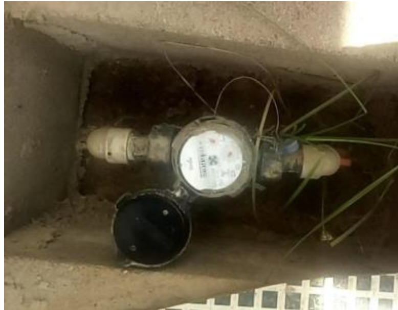
Figura 73 – Hidrômetro Fonte: INSTITUTO GESOIS, 2021.
