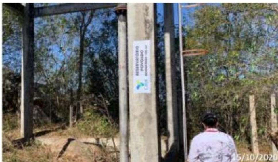
Figura 61 – Reservatório Povoado Boqueirão Fonte: ARSAL, 2020.
